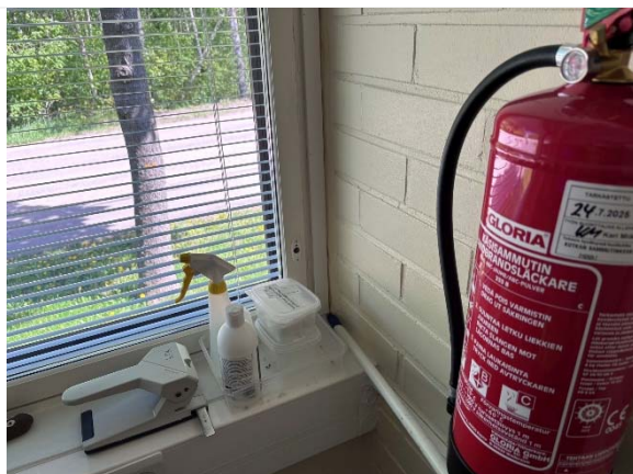
Kuva 4. Ilmavuotokohta ikkunan karmista/liitoskohdasta.
