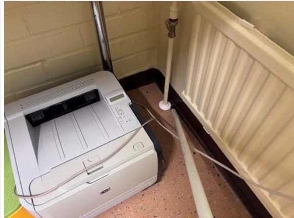
Kuva 3. Ilmavuotokohta patteriputken juuresta.
