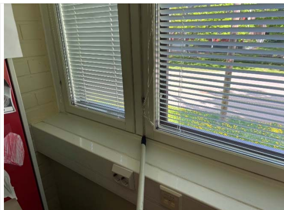
Kuva 5. Ilmavuotokohta ikkunan karmista/liitoskohdasta.
