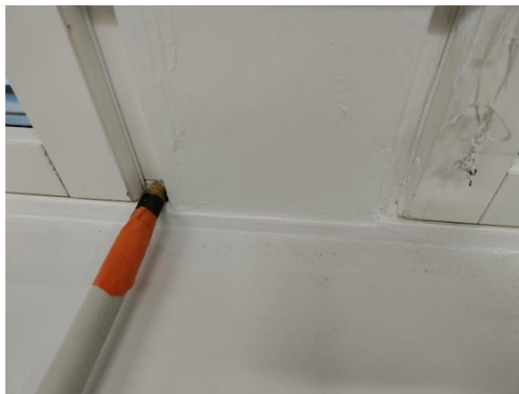
Kuva 4. Ilmavuotokohta ikkunan karmista/liitoskohdasta.
