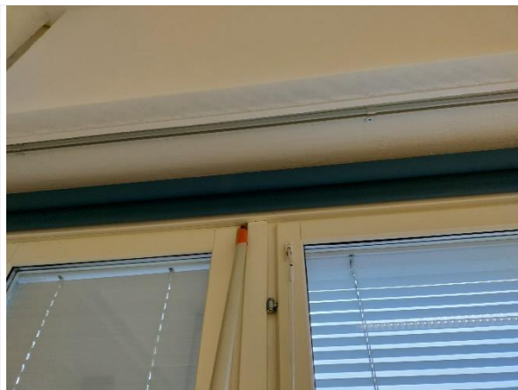
Kuva 5. Ilmavuotokohta ikkunan karmista/liitoskohdasta.
