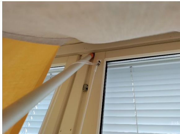
Kuva 9. Ilmavuotokohta ikkunan karmista/liitoskohdasta.
