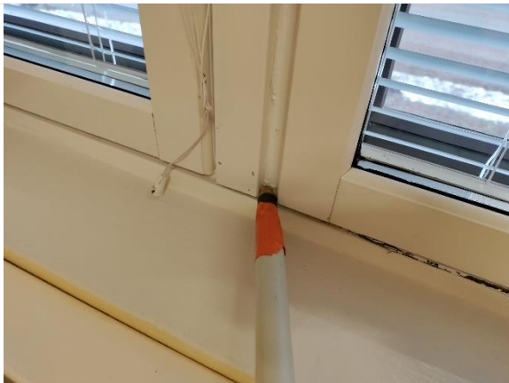
Kuva 8. Ilmavuotokohta ikkunan karmista/liitoskohdasta.
