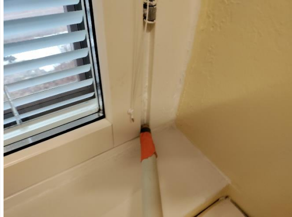
Kuva 7. Ilmavuotokohta ikkunan karmista/liitoskohdasta.
