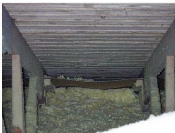
Kuva 30. Puhallusvillan asennuksen yhteydessä on todennäköisesti asennettu räystäälle tuulenohjauslevyt
