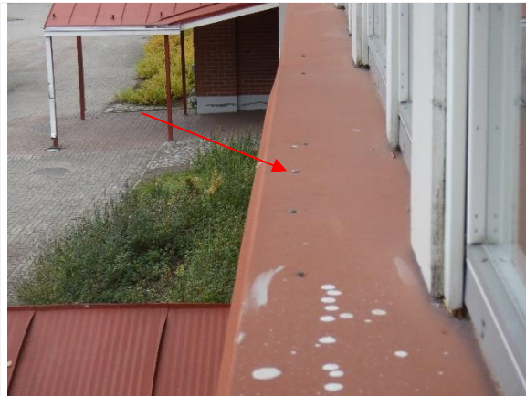
Kuva 13. Ikkunapellityksen puutteellista kaatoa on pyritty korjaamaan ruuveilla
