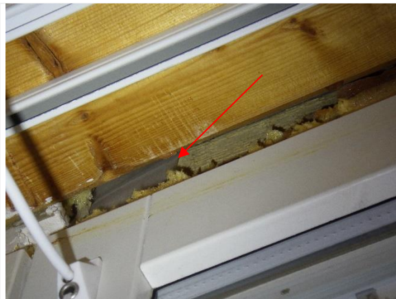
Kuva 19. Levyrakenteiden ulkoseinän muovikalvo loppuu ikkunoiden puurakenteen liittymään
