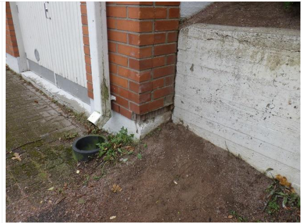
Kuva 2. Rinteessä sokkelin ulkopinnalla havaittiin bitumisively. Kuva pohjakerroksesta entisen autotallin vierestä
