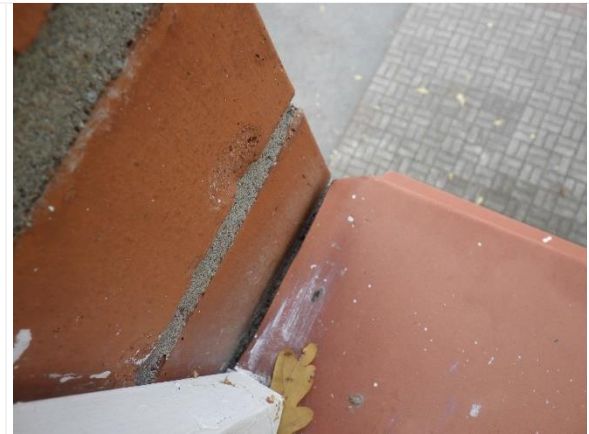
Kuva 14. Ikkunapellitysten liittymä tiilijulkisivuun on epätiivis
