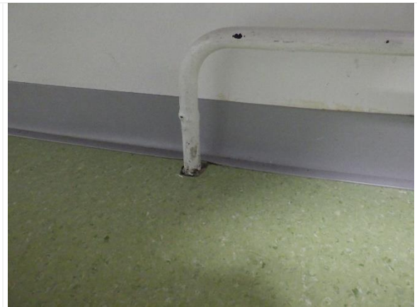
Kuva 21. Yksittäisiä läpivientejä havaittiin epätiiviksi
