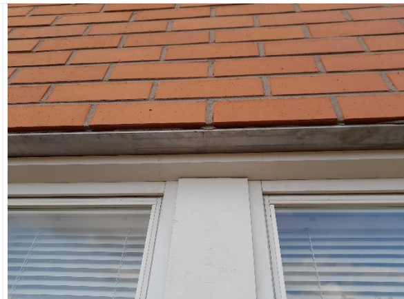
Kuva 10. Ulkoseinän yläosassa ei ole tuuletusaukkoja (1. ja toisen kerroksen välinen seinäosuus)
