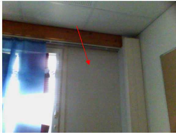
Kuva 11. Tilan 201-209 ulkoseinässä havaittiin lämpökameralla viileä kohta (viereinen kuva)
