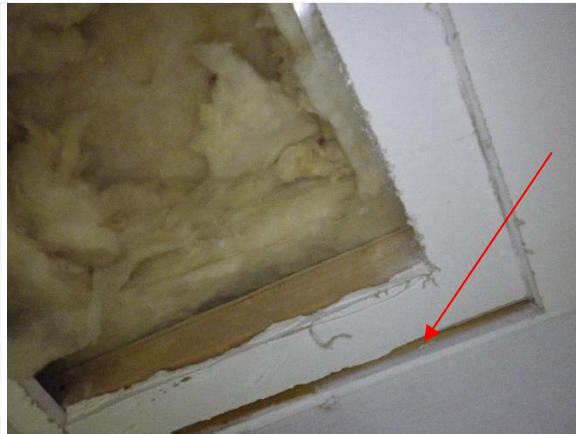
Kuva 26. Yläpohjan muovikalvo päättyy liimapuupalkin sisäpintaan
