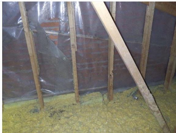
Kuva 28. Rakennuksen länsipääty, jossa ulkoseinän muovia on jatkettu yläpohjatilaan
