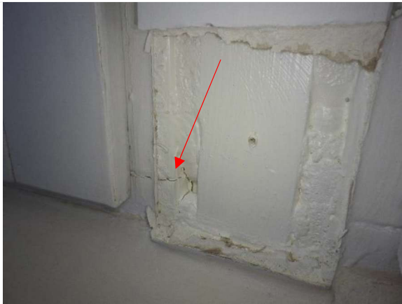
Kuva 17. Ikkunan välinen rakenne tiivistetty. Tiivistyksessä halkeama
