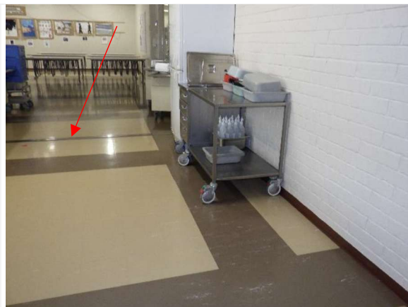
Kuva 11. Lattian liikuntasauma havaittiin tiivistetyksi
