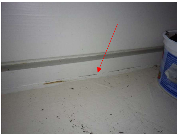
Kuva 28. Ikkunalistoituksessa halkeamia, ei havaittu vuotoja
