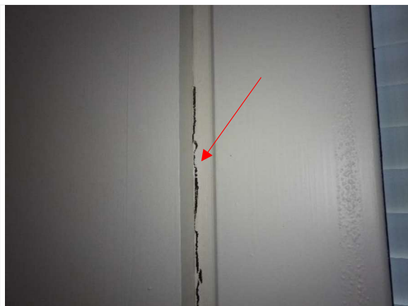
Kuva 31. Ikkunan välisen levyrakenteen ja ikkunapuitteen liittymissä halkeamia
