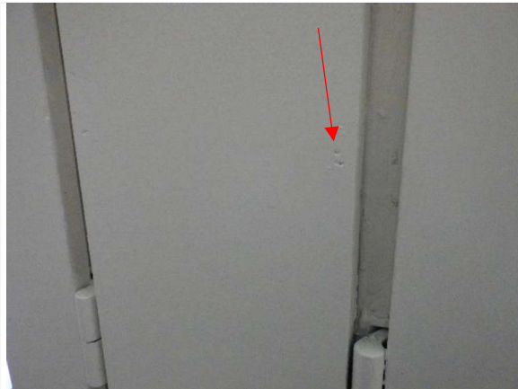
Kuva 33. Ikkunan väliset levyt on naulattu. Naulaus rikkoo tiivistyskorjausta
