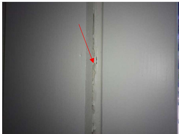
Kuva 29. Ikkunan välisissä rakenteissa halkeamia, havaittiin vuotoja
