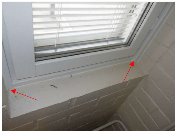
Kuva 12. Sos. tila 188 ulkoseinä, vuotokohtat nuolella
