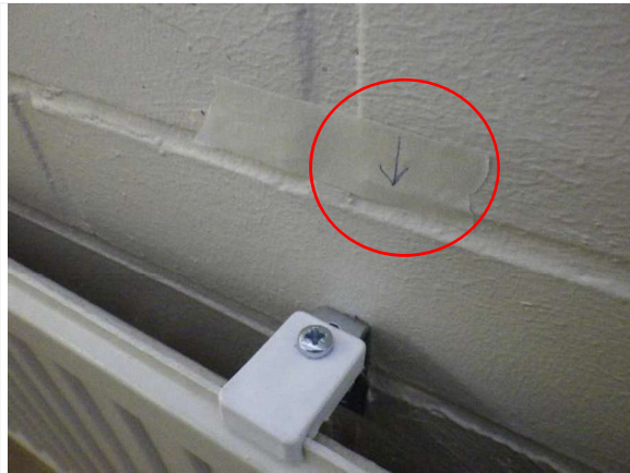
Kuva 10. Vuotokohtat on merkattu teipein
