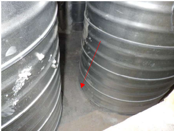
Kuva 22. IV-kotelon lattiapintaa ei ole tiivistetty
