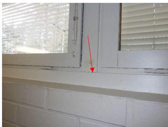
Kuva 14. Sostila 188, vuotokohta nuolella
