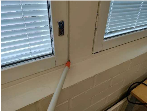
Kuva 43. Ikkunan liitoskohdasta havaittiin ilma- vuotoa.
