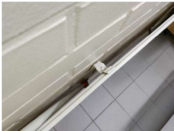
Kuva 21. Patterin kannakkeista havaittiin ilmapuotoa.
