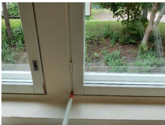
Kuva 60. Ikkunanliitoksesta havaittiin ilmavuo- toa.
