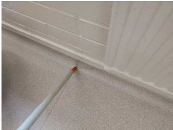
Kuva 30. Muovimaton saumasta havaittiin ilma- vuotoa.
