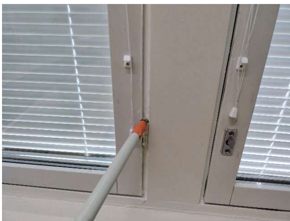
Kuva 17. Ikkunanliitoksesta havaittiin vähäistä ilmapuotoa.
