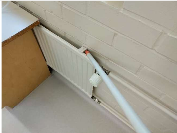
Kuva 56. Patterin kannakkeesta havaittiin ilma- vuotoa.
