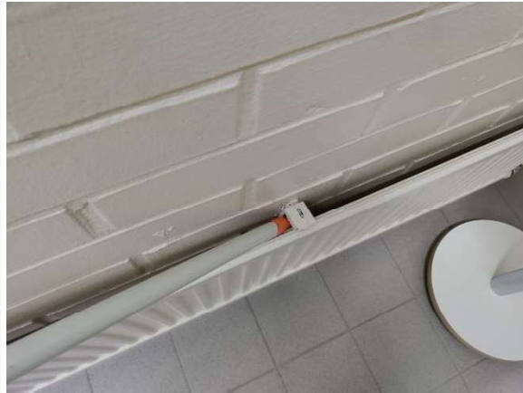
Kuva 14. Patterin kannakkeista havaittiin ilmapuotoa.
