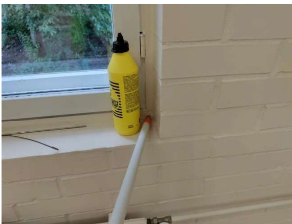
Kuva 59. Ikkunapenkin nurkasta havaittiin ilma- vuotoa.
