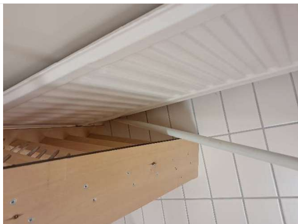
Kuva 65. Vuotopaikka lattian/seinän liittymästä.
