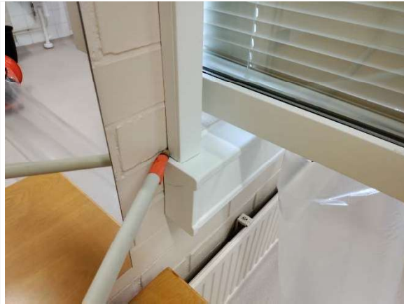
Kuva 48. Sähkökourun takaa havaittiin ilmavuotoa.
