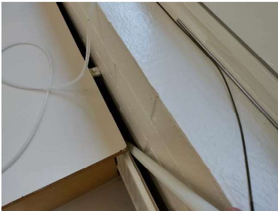
Kuva 57. Patterin kannakkeesta havaittiin ilma- vuotoa.
