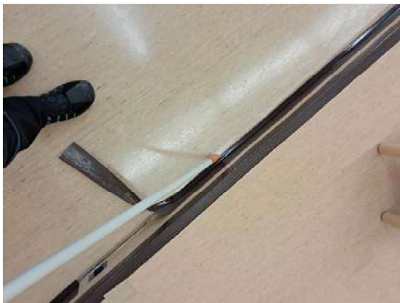
Kuva 92. Korokkeen keskellä havaittiin yksittäinen ilmavuotopaikka.
