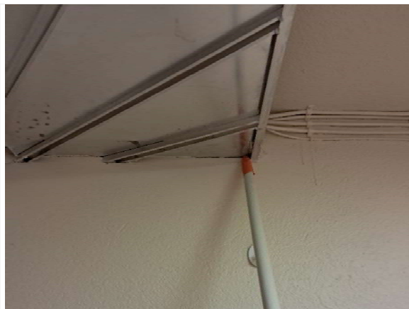
Kuva 72. Vuotopaikka käytävällä sähköhyllyn läpiviennistä.
