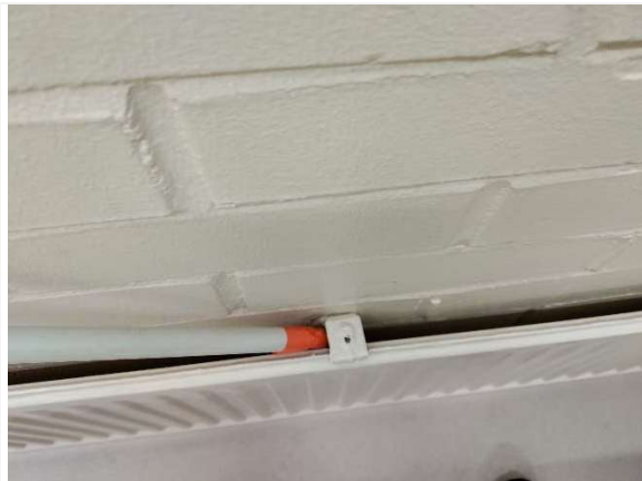
Kuva 42. Patterin kannakkeesta havaittiin ilma- vuotoa.
