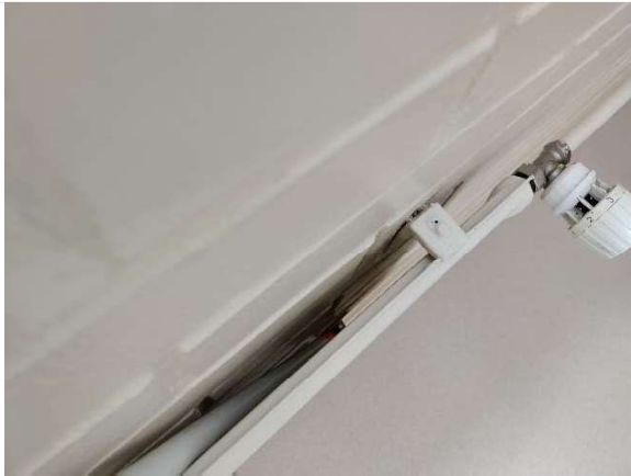
Kuva 27. Patterin kannakkeista havaittiin ilma- vuotoa.
