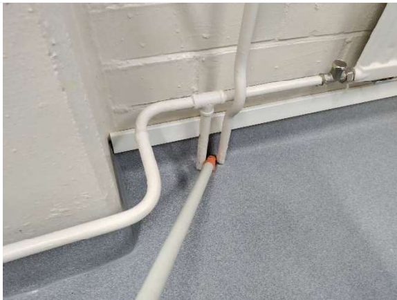
Kuva 53. Patteriputkien läpiviennistä havaittiin ilmapuotoa.
