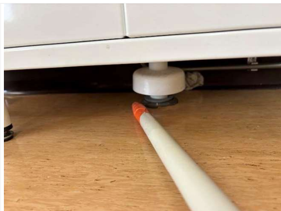
Kuva 93. Ilmavuotopaikka korokkeen viemärin läpiviennistä.
