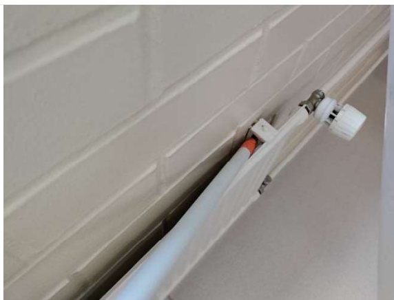
Kuva 26. Patterin kannakkeista havaittiin ilma-vuotoa.
