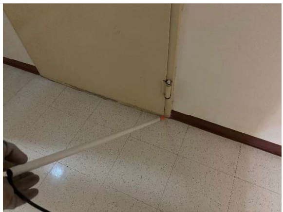
Kuva 67. Vuotopaikka alapohjan kautta lämmönjakuhuoneen oven juuresta.
