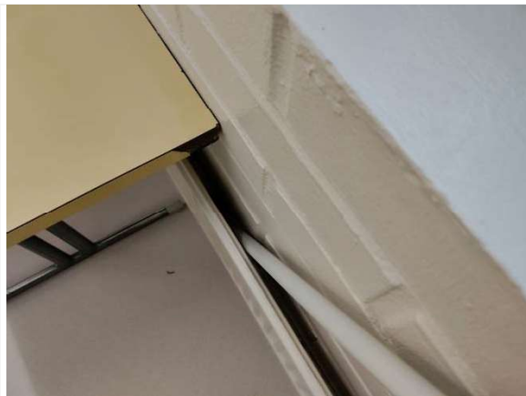
Kuva 38. Patterin kannakkeesta havaittiin ilmapuotoa.
