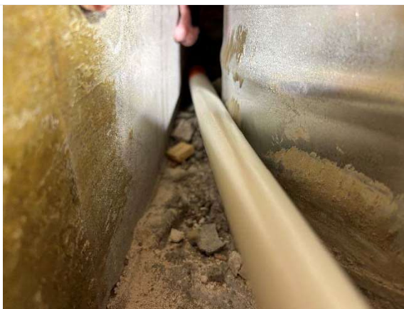
Kuva 94. Ilmavuotopaikka IV-pystyhormin sisällä.
