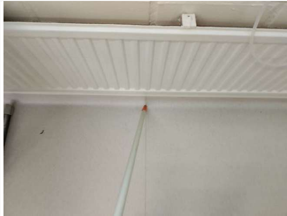
Kuva 40. Muovimaton saumoista havaittiin il- mavuotoa.
