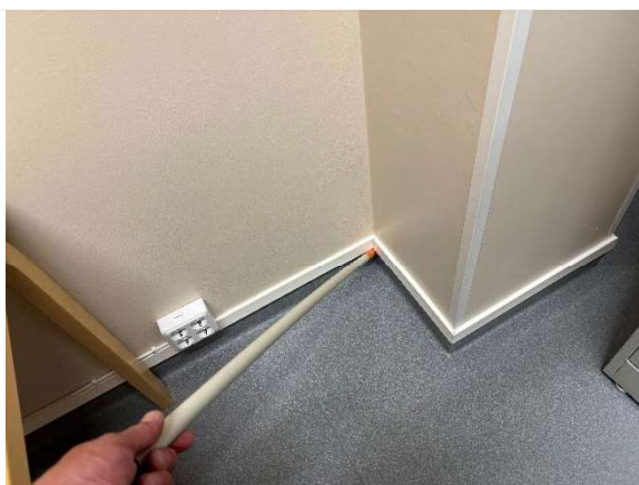
Kuva 88. Ilmavuotopaikka kotelon alareunasta.
