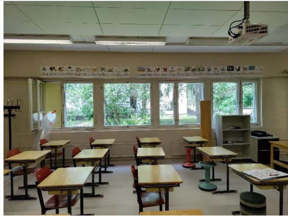
Kuva 36. Tilassa 257 ei havaittu ilmapuotoja ulkoseinärakenteesta.
