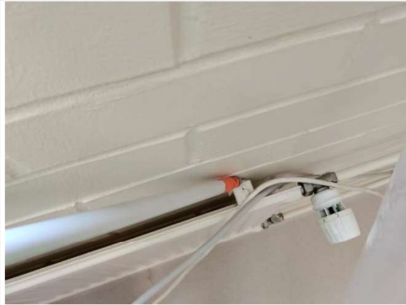
Kuva 32. Patterin kannakkeista havaittiin ilma-vuotoa.
