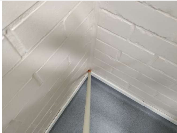
Kuva 52. Muovimaton ylösnostosta nurkassa havaittiin ilmapuotoa.
