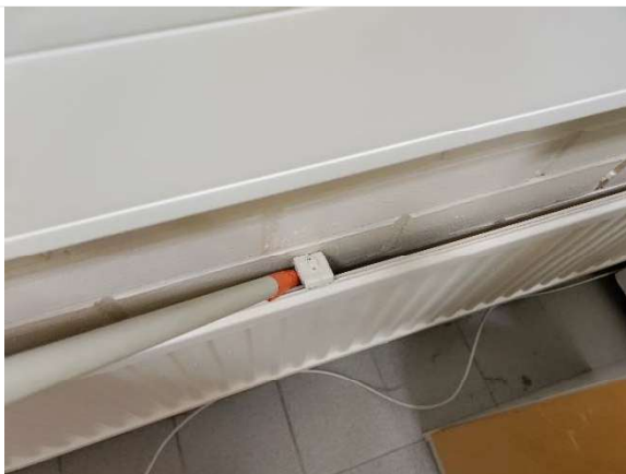
Kuva 2. Yksittäisestä patterin kannakkeesta havaittiin il-mavuotoa.
