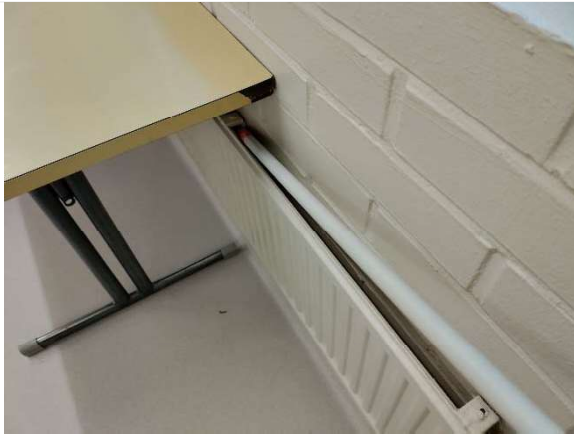
Kuva 39. Patterin kannakkeesta havaittiin ilma- vuotoa.
