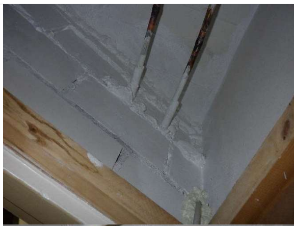
Kuva 95. Käytävän 304 sähkökaapista ei havaittu ilmayhteyttä ullakolle.
