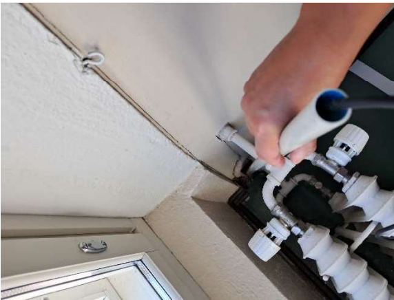
Kuva 81. Ilmavuotopaikka musiikkiluokan 203 patteriputken läpiviennistä.
