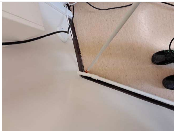
Kuva 91. Ilmavuotopaikka opettajan korokkeen ja ulkoseinän liitoskohdassa.
