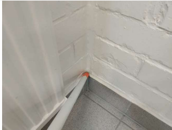
Kuva 10. Ulkoseinän ja väliseinän alanurkassa havaittiin vähäistä vuotoa.
