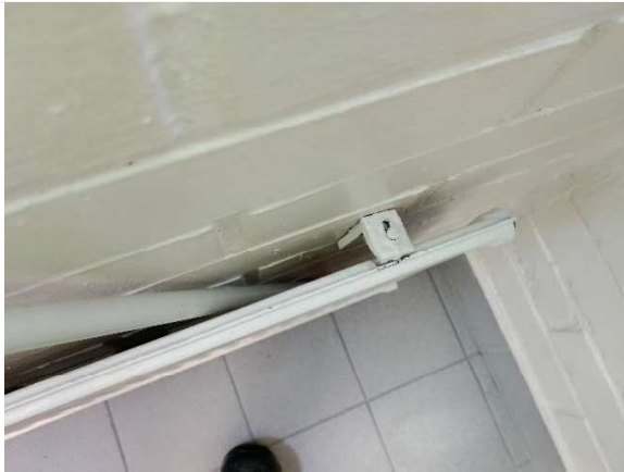
Kuva 9. Patterin kannakkeista havaittiin ilma- vuotoa.
