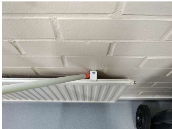
Kuva 50. Patterin kannakkeesta havaittiin ilmavuotoa.
