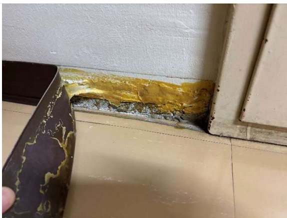
Kuva 78. Lattian seinän liittymästä puuttuu tiivistys.
