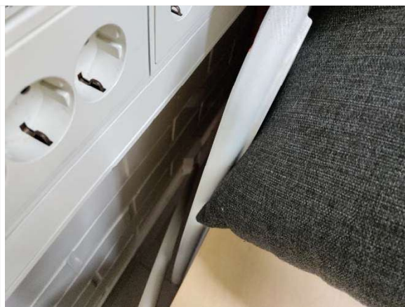
Kuva 18. Alapohjarakenteesta havaittiin voimakasta ilmapuotoa pistorasian kautta.
