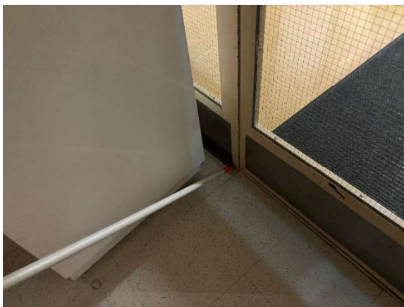
Kuva 68. Vuotopaikka alapohjan kautta palo-oven juuresta.
