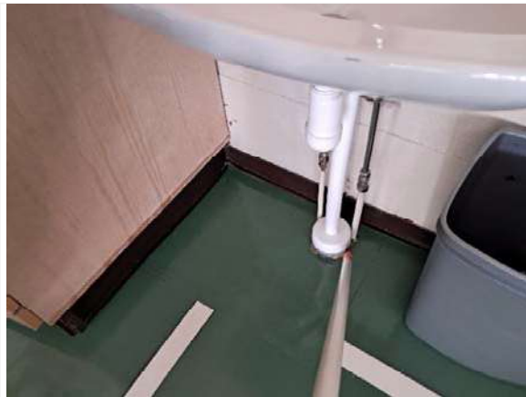
Kuva 82. Ilmavuotopaikka musiikkiluokan 203 käsienvesualtaan putkiläpiviennistä.
