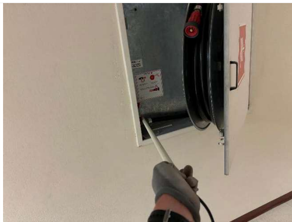
Kuva 71. Vuotopaikka käytävän palopostin kautta.
