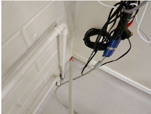
Kuva 28. Muovimaton ylösnostosta havaittiin il- mavuotoa nurkassa.
