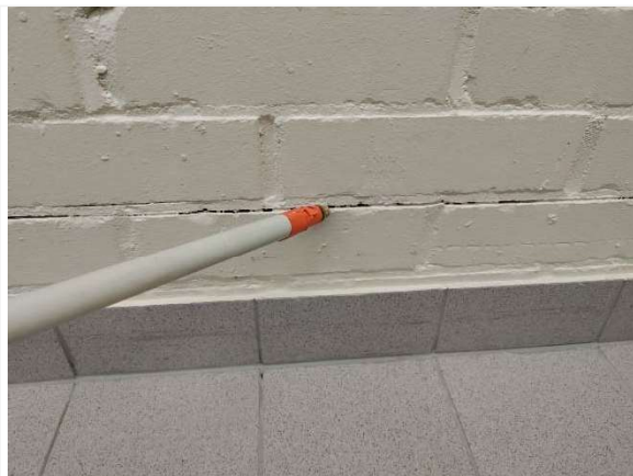
Kuva 22. Alapohjarakenteesta havaittiin voimakasta ilmapuotoa väliseinärakenteen halkeaman kautta.
