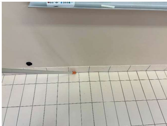
Kuva 61. Ilmavuotopaikka lattia/seinän liittymästä.
