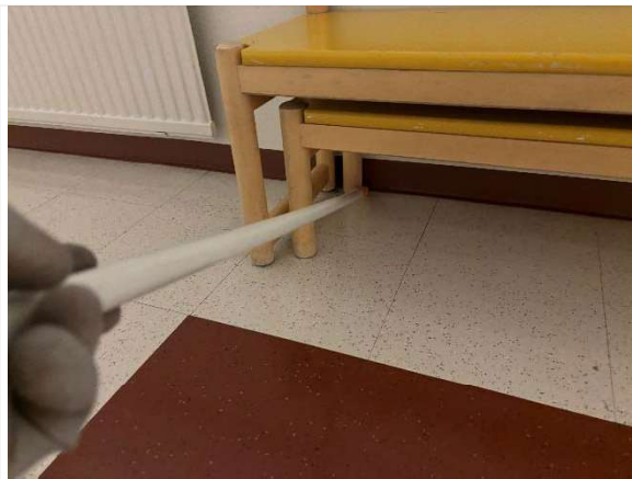
Kuva 70. Vuotopaikka alapohjan kautta seinän/lattian juuresta.
