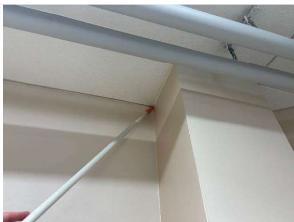
Kuva 87. Ilmavuotopaikka kotelon yläreunasta.
