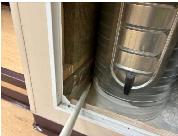
Kuva 90. Ilmavuotopaikka IV-pystyhormin sisältä.
