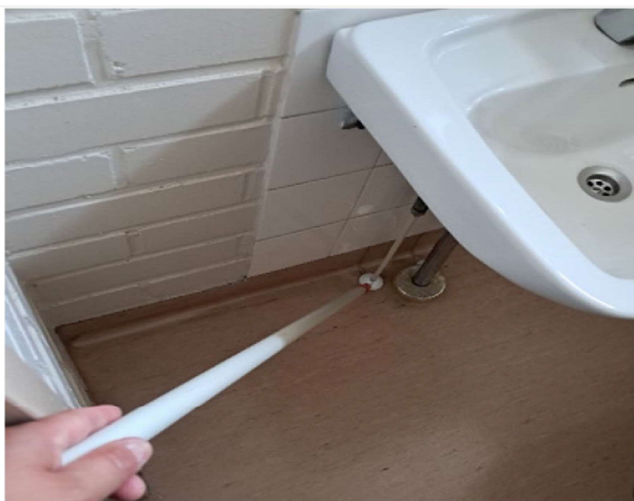
Kuva 75. Vuotopaikka vesiputken läpiviennistä.
