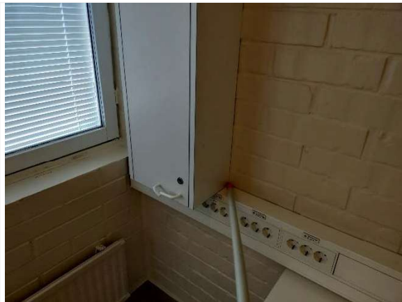
Kuva 12. Kaapin takaa väliseinärakenteesta ha- vaittiin ilmavuotoa.
