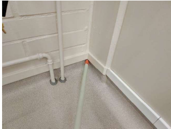
Kuva 44. Muovimaton ylösnostosta nurkassa havaittiin ilmavuotoa.
