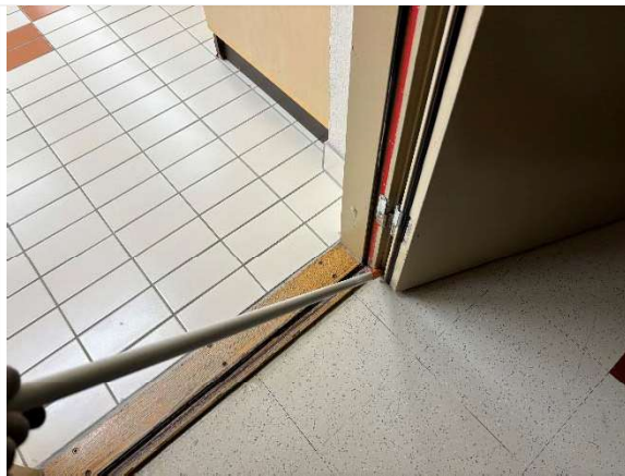
Kuva 69. Vuotopaikka alapohjan kautta luokan oven juuresta.
