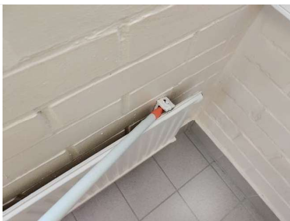
Kuva 8. Patterin kannakkeista havaittiin ilma- vuotoa.
