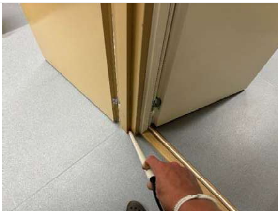
Kuva 86. Ilmavuotokohta ovenkarmen juuresta.
