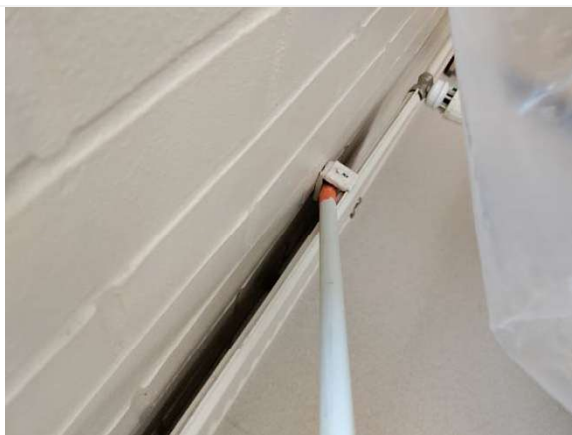
Kuva 24. Patterin kannakkeista havaittiin ilma-vuotoa.
