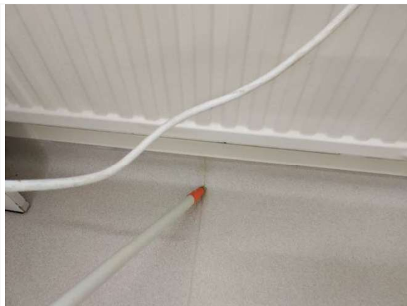
Kuva 34. Muovimaton saumasta havaittiin ilma-vuotoa.
