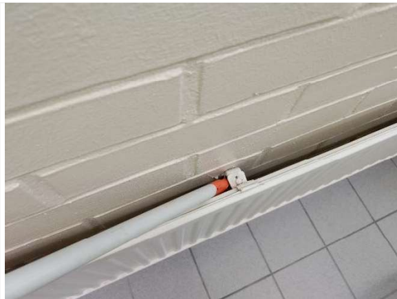
Kuva 20. Patterin kannakkeista havaittiin ilmapuotoa.
