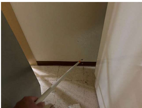
Kuva 64. Ilmavuotopaikka seinässä olevasta reiästä käytävän puolella.
