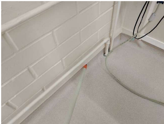
Kuva 29. Muovimaton ylösnostosta havaittiin il- mavuotoa nurkassa.
