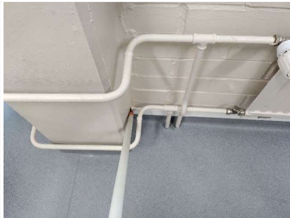
Kuva 54. Muovimaton ylösnostosta pilarin nurkassa havaittiin ilmapuotoa.
