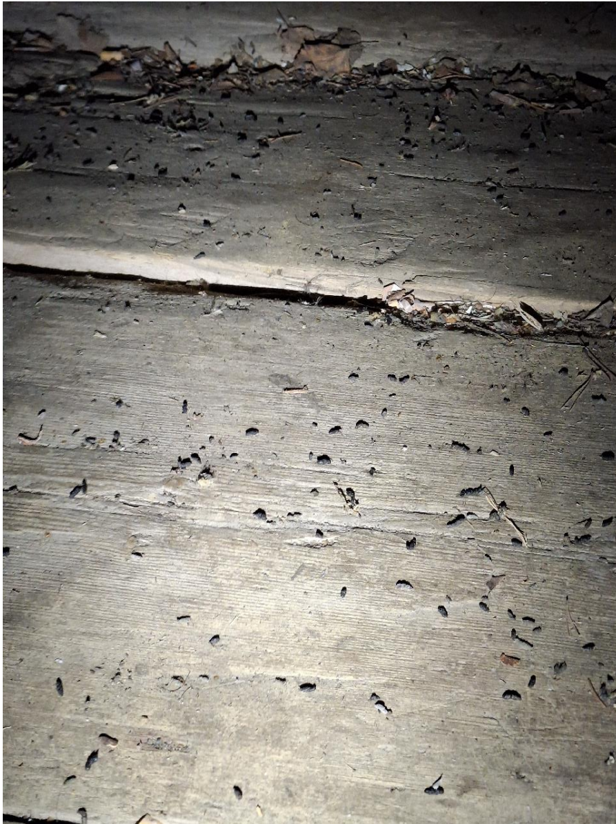
Kuva 6-5. Lepakon papanoita lattialla toisen rakennusselvityskäynnin aikana. Osa papanoista on vanhoja harmaita, osa tuoreempia.
