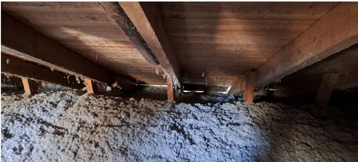
Kuva 6-11. Liisanpirtin yläpohjaa. Papanoita havaittiin eristysvillalla, ja lepakot todennäköisesti ovat levähtäneet myös ruoteiden lautaverhoilussa ja kattotuoleissa.
