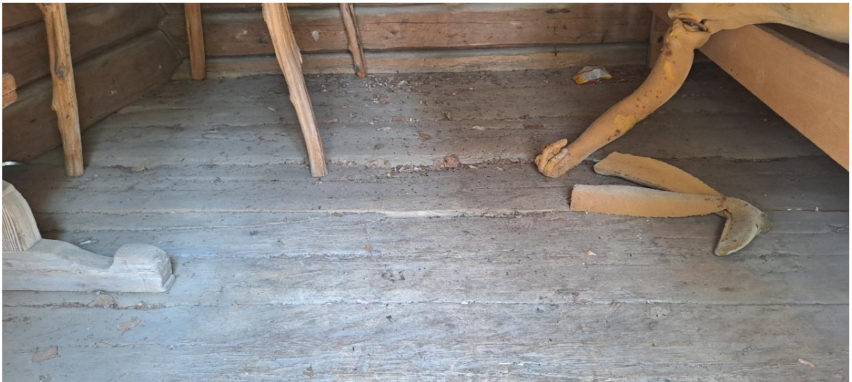
Kuva 6-4. Itäisen rakennuksen (Kuva 6-3, oikeanpuoleinen rakennus) lattialla on havaittavissa lepakon papanoita ensimmäisellä selvityskäynnillä.
