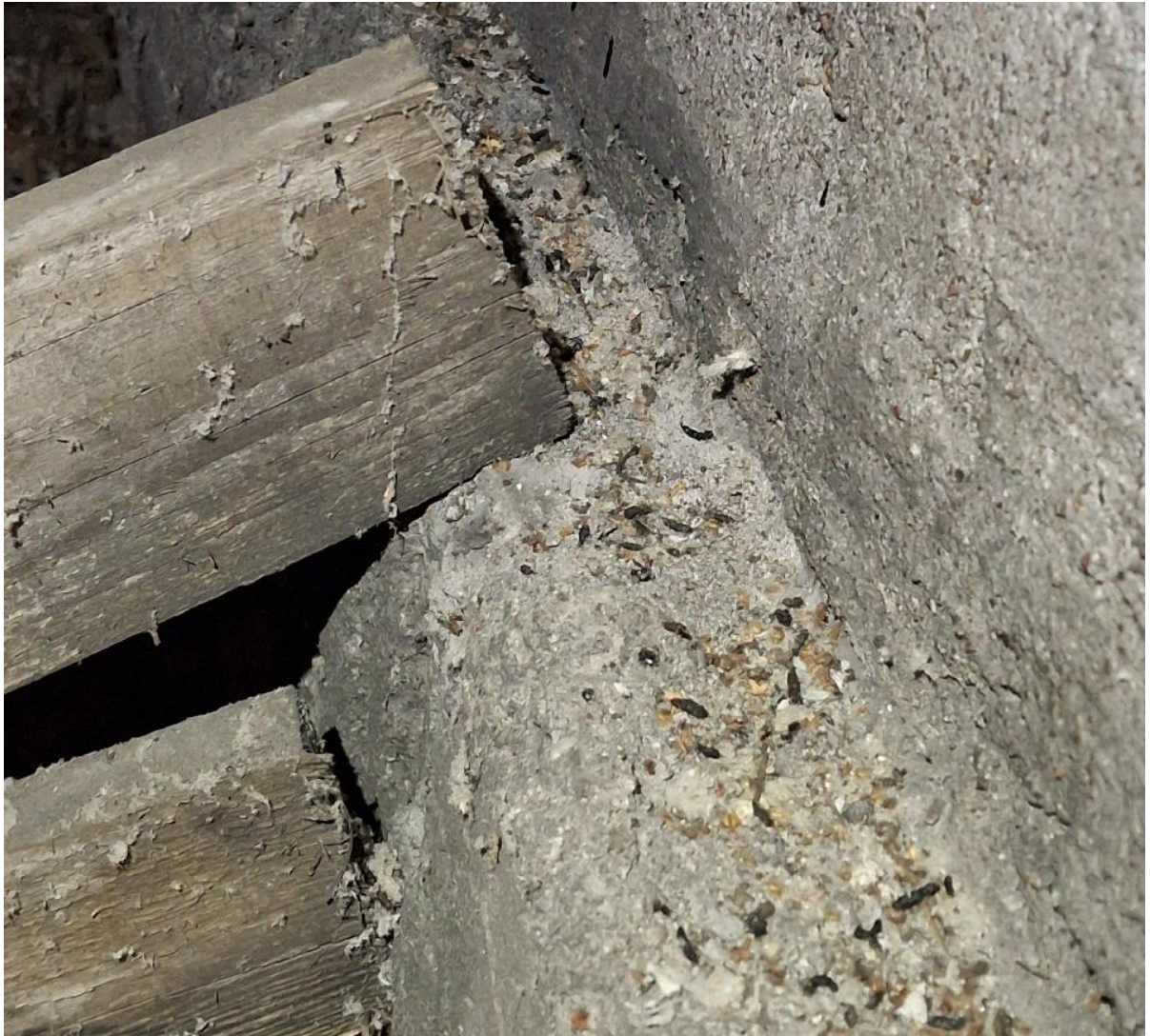
Kuva 6-12. Papanoita savupiipun varressa toisella rakennusselvityskäynnillä.
