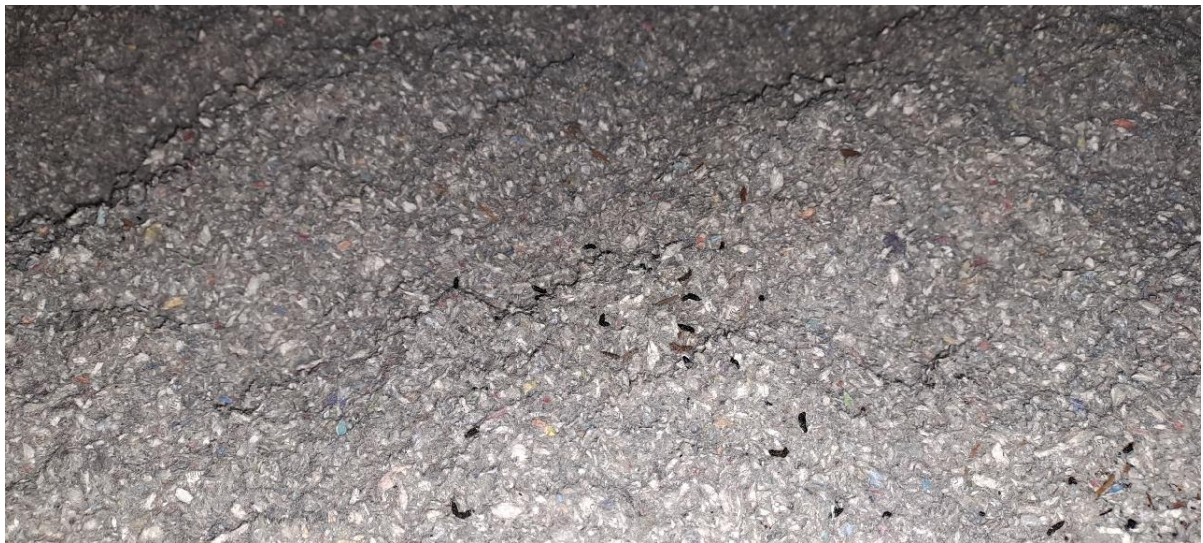
Kuva 6-13. Mustana kiiltäviä, tuoreita papanoita eristevillan päällä ensimmäisellä selvityskäynnillä. Lautaverhoilusta roikkunut lepakko on jättänyt jälkeensä papanoita, jotka näkyvät helposti vaalean villan pinnalla.
