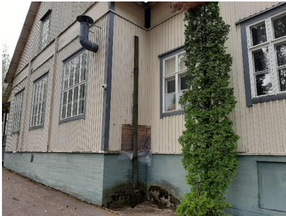
Rakenneavauskohta RA.09-US. Kohdassa syök-syputki irti räystäältä.
