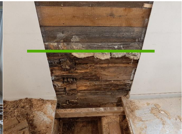
Vihreällä viivalla esitetty hirsirungon ja laudoituksen raja. Hirressä merkittävää lahovaurioitumista
