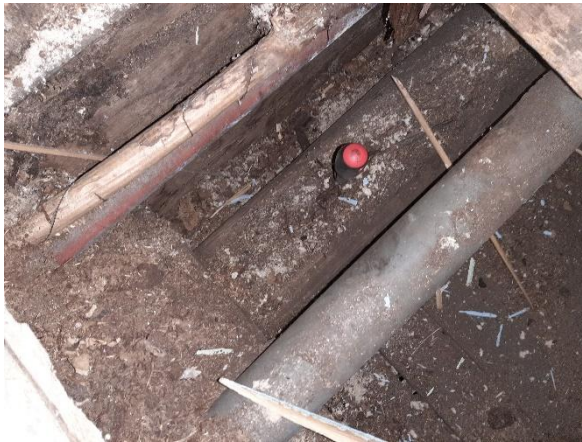
Vesipisteen kohdalla primääripalkki täysin lahovaurioitunut. Seuraavassa palkissa kauempana vesipisteestä ei havaittu lahovaurioitumista
