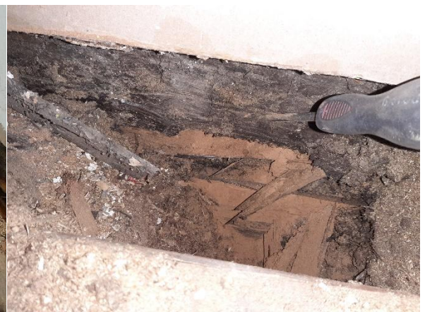
Alimmissa hirsissä lahovaurioitumista rakenneavauskohdassa RA.03-AP
