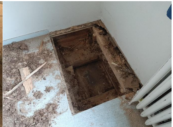
Alapohjarakenteen rakenneavauskohdassa RA.03-AP todettiin ulkoseinärakenteen alimmissa hirsissä lahovaurioitumista
