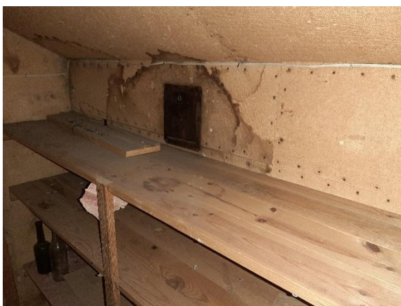
Yhdessä toisen kerroksen varastoista ulkoseinässä kosteusjälkiä
