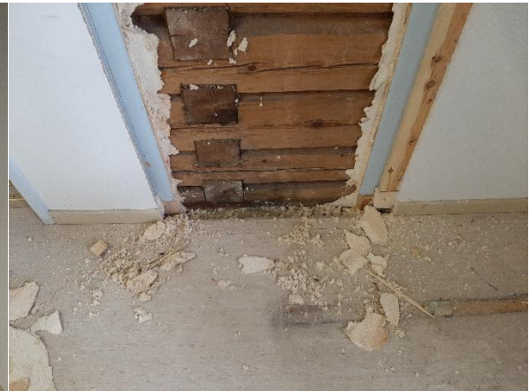
Hirsissä ei todettu sisäpuolella lahoa. Lattian rajassa oleva hirsi lievästi tummunut
