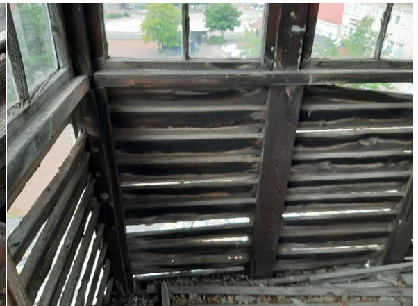
Ilmanvaihtotornin puurakenteissa lahovaurioita
