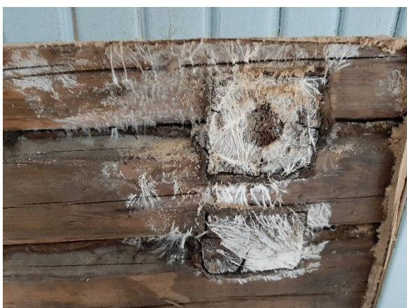
Hirren sisäpinnassa näkyvää mikrobikasvustoa. Rakenneavauskohdassa hirressä ei todettu merkittävää lahovaurioitumista
