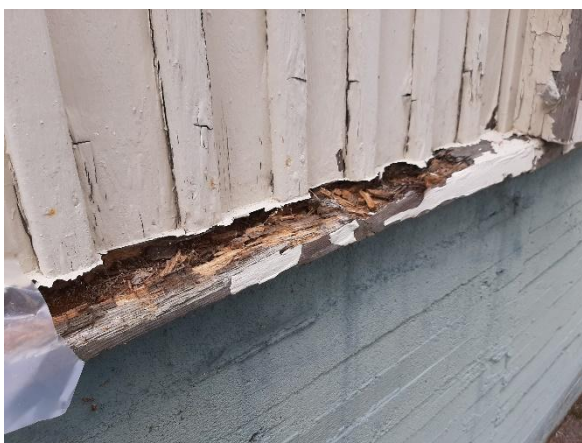
Rakenneavauksen kohdalla alapuu lahovaurioitunut
