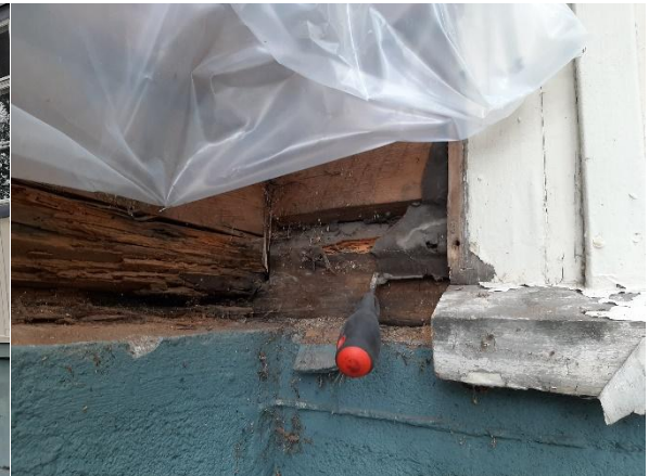
Alimassa hirressä lahovaurioitumista
