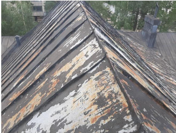
Vesikatteen pinnoite irtoilee. Peltikatteen pinnassa on ruostetta
