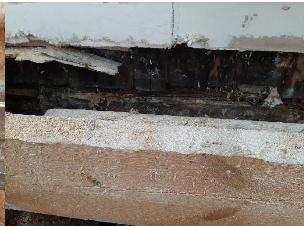
Välipohjan ja seinän liittymässä näkyvissä tummuneita alkuperäisiä seinäpaneeleita
