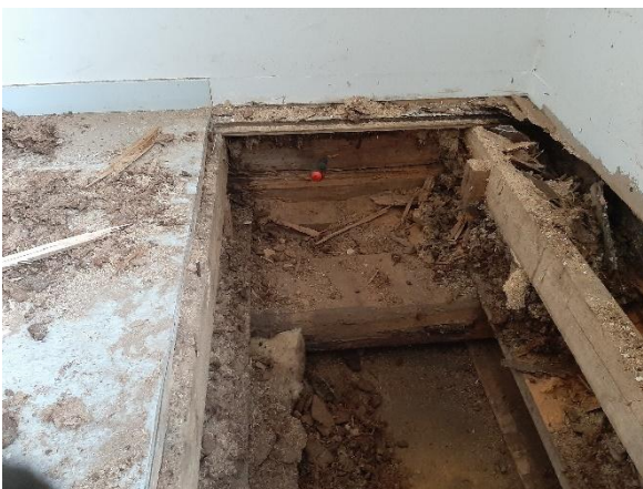
Alimmissa hirsissä lahovaurioita rakenneavauskohdassa RA.03-AP
