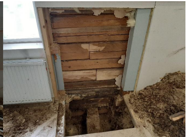
RA.13-US, hirsissä ei todettu lahovaurioitumista
