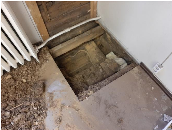
Rakenneavauksessa RA.05-AP ei havaittu alapohjan puurakenteissa lahovaurioitumista
