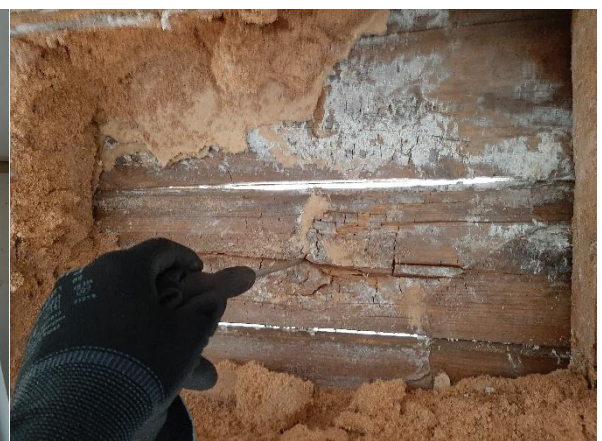
julkisivulauta lahovaurioitunut avauskohdasta, vaakalaudoituksen väleistä sadevesi pääsee vapaasti kulkeutumaan julkisivurakenteeseen
