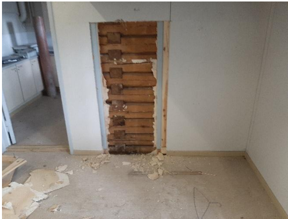
Rakenneavauskohta RA.15-US, ulkopuolella räystäältä irti oleva syöksyputki
