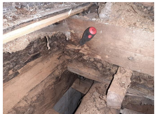
Puupalkissa havaittavissa ulkonurkassa lahovaurioitumista, muuten ei havaittu lattian puurakenteissa lahovaurioitumista (RA.02)
