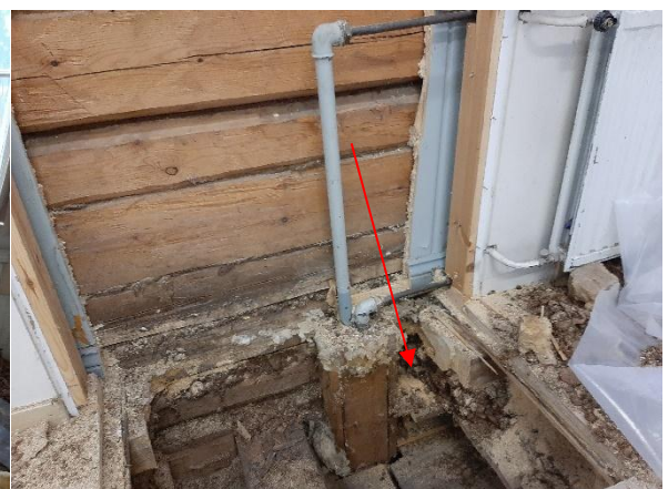
Toiseksi alimmassa hirressä todettiin paikallisesti sisäpinnassa lahovaurioita
