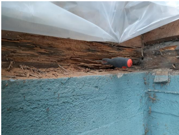
Alimassa hirressä lahovaurioitumista
