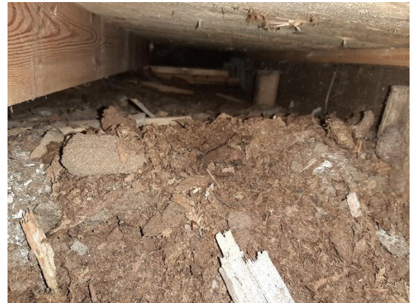
Rakenteessa lattialaudan alapuolella ilmarako
