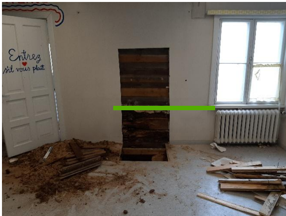
Rakenneavauskohta RA.16-US 2.krs alapuolella hirressä näkyvää mikrobikasvustoa. Vihreällä esitetty hirsirungon ja pystyrungon raja
