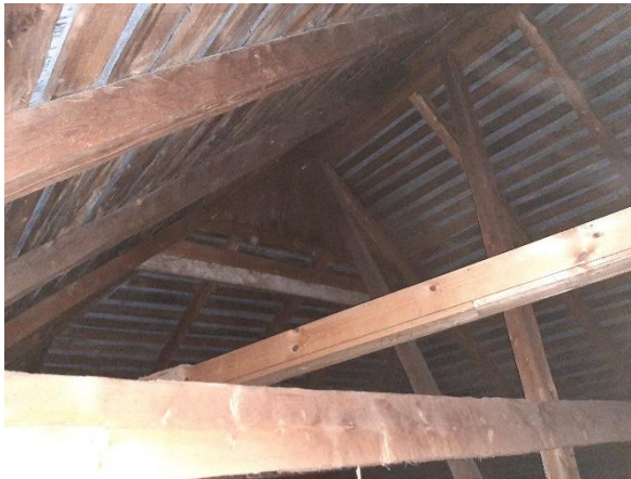
Vesikatteessa näkyvissä yksittäisiä reikiä
