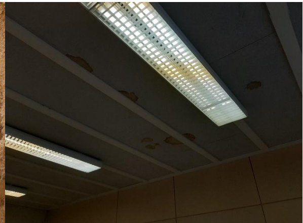
Rakenneavauksen alapuolella näkyvissä vanhoja kosteusjälkiä
