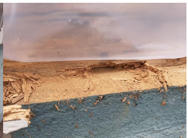
Rakenneavauksessa RA.08-US alimmassa hirressä sokkelin liittymässä lahovaurioitumista
