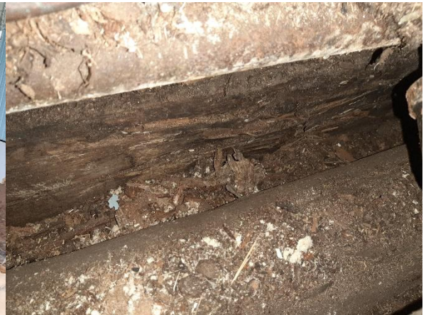
Lattiapinnan alapuolella vesipisteen kohdalla väliseinähirret lahovaurioituneet
