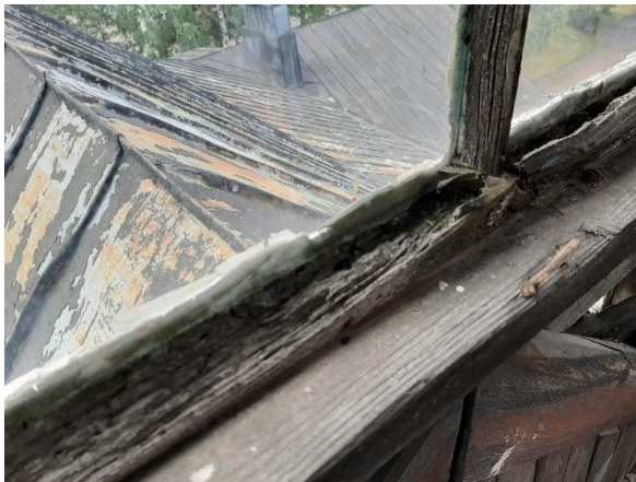
Ilmanvaihtotornin puurakenteissa lahovaurioita
