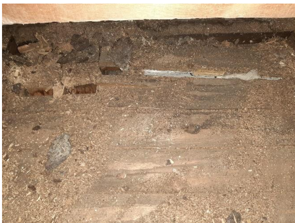
Välipohjan alapinnan laudoituksessa vaurioita
