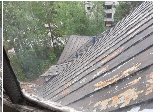
Vesikatteen pinnoite irtoilee. Peltikatteen pinnassa on ruostetta
