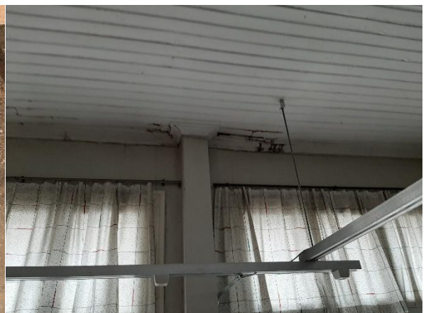
Alapuolella näkyvissä kosteusjälkiä. Purueristettä valunut 1.kerroksen lattialle
