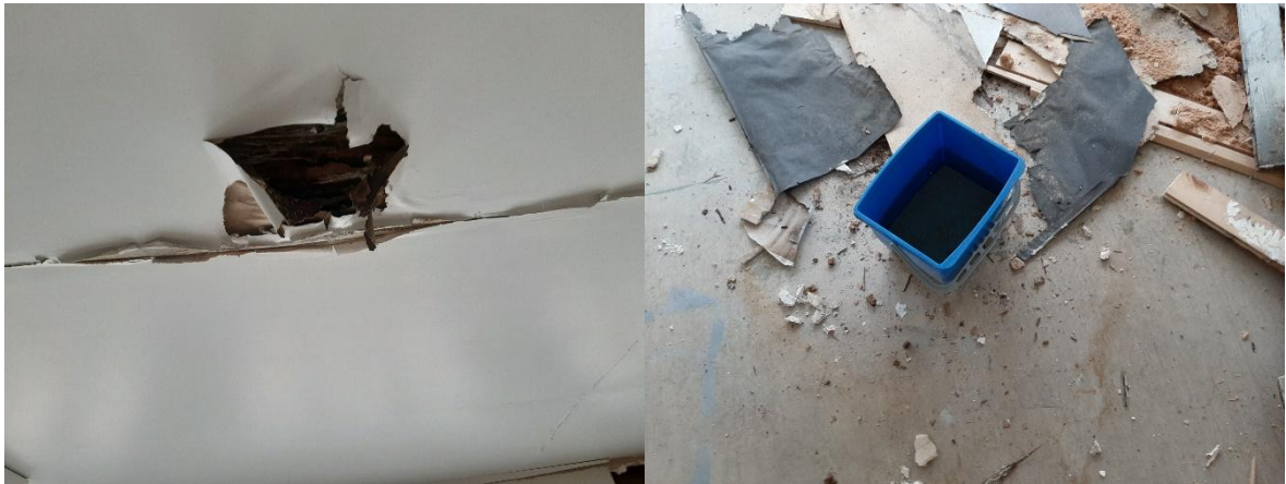
2.kerroksen luokkatilassa katosta tullut vedet si- Luokan lattialla olevassa ämpärissä vettä sälle
