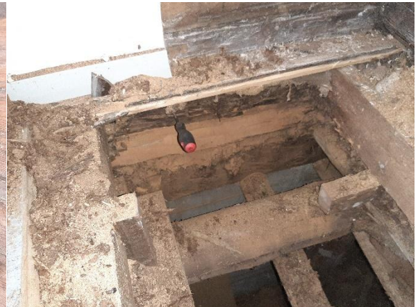
Lattiapinnan alapuolella toiseksi alin hirsi lahovaurioitunut
