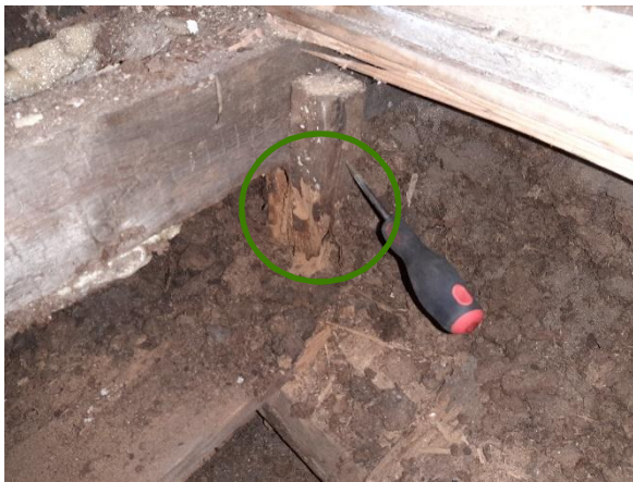
Palkkien kannattimissa lahovaurioita
