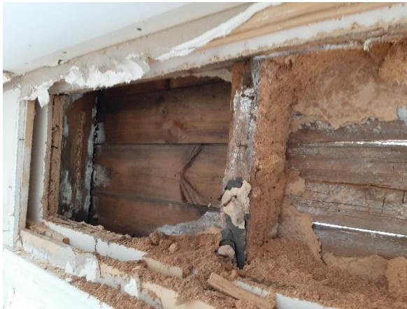
Näkyvää mikrobikasvustoa rakenteessa. Rakenteen lämmöneristeenä on puru
