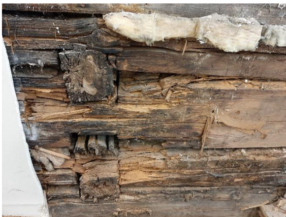
Seinän ulkonurkassa hirret lahovaurioituneet
