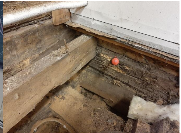
Rakenneavauksessa toiseksi alimmassa hirressä lahovaurioita
