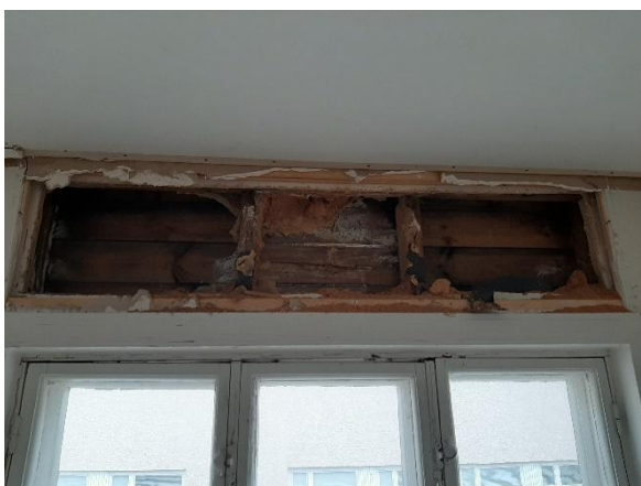
Julkisivulaudan sisäpinnassa näkyvää mikrobikasvustoa. Lautojen välistä paistaa ulkoilma
