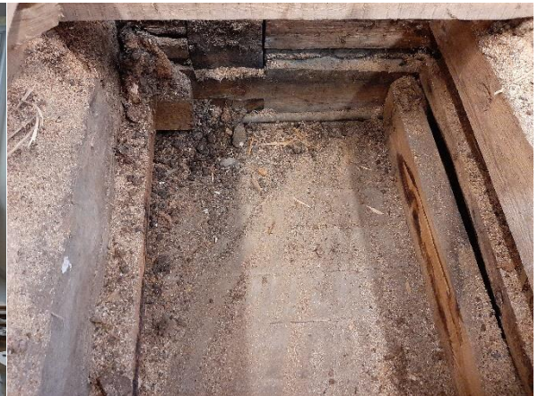
Välipohjarakenteessa ei havaittu kantavissa rakenteissa lahovaurioitumista
