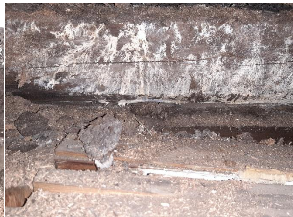
Välipohjan kohdalla hirressä näkyvää mikrobikasvustoa
