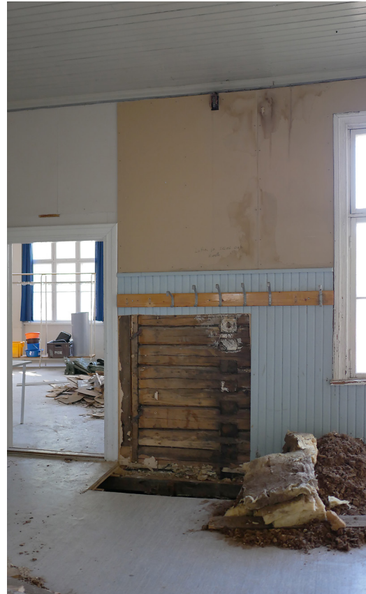
↑ Sitowisen rakenneavaus eteisaulan ja opetustilan 2009 väliltä. Peltikaton sisäjiiri on vuotanut. Amoy 2020
