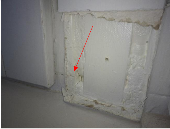
Kuva 17. Ikkunan välinen rakenne tiivistetty. Tiivistyksessä halkeama
