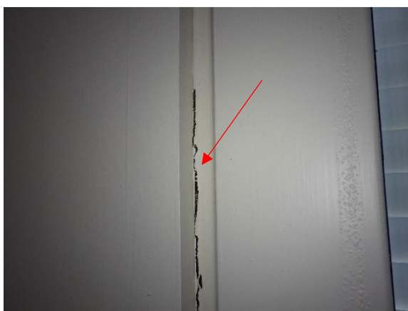
Kuva 31. Ikkunan välisen levyrakenteen ja ikkunapuitteen liittymissä halkeamia
