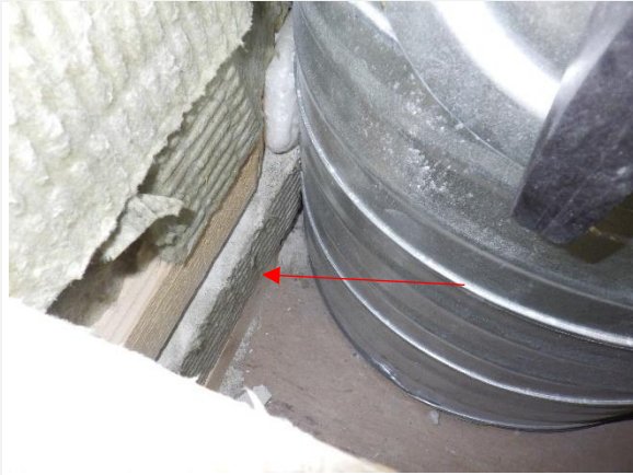
Kuva 21. Betonikorokkeen liittymää ei ole tiivistetty, muovimatto on osin paikallaan
