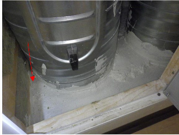
Kuva 18. Luokkatilan nurkissa kulkee IV-kotelo. Massaus on toteutettu puurunkoa vasten, ei betonikoroketta (kuvassa runkojen välissä mineraalivilla)
