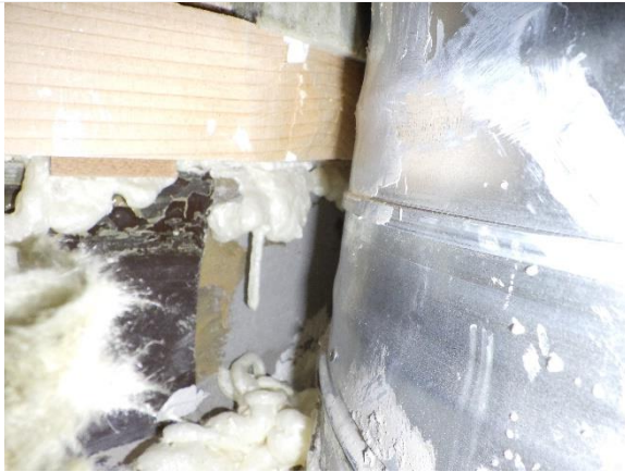
Kuva 25. Korokkeen betonirakennetta ja sen tiivistystä oli hankala havainnoida ahtauden vuoksi, liittymiä on tiivistetty
