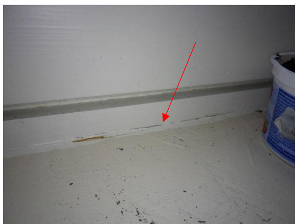
Kuva 28. Ikkunalistoituksessa halkeamia, ei havaittu vuotoja
