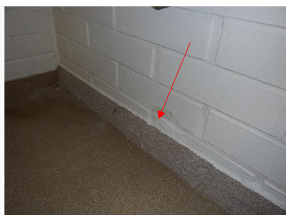
Kuva 13. Sos. tilan 188 ulkoseinän ja lattian liittymä, vuotokohta nuolella
