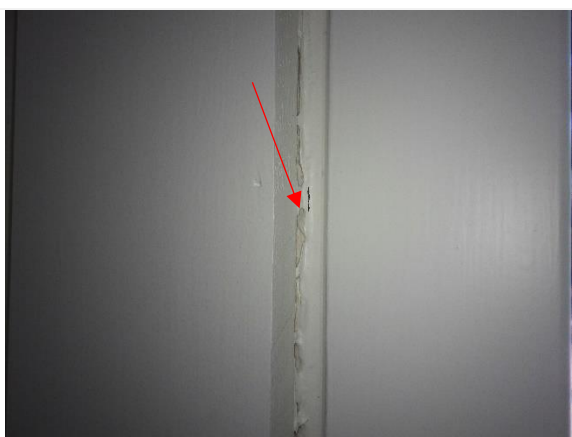
Kuva 29. Ikkunan välisissä rakenteissa halkeamia, havaittiin vuotoja
