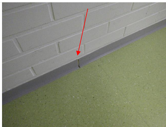
Kuva 22. Osa lattialistoista eivät ole tiiviitä
