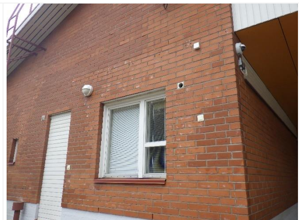
Kuva 16. Rakennuksen länsipäädystä havaittiin tiilipinnassa paikoin härmettä
