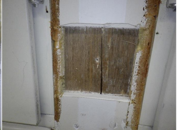
Kuva 7. Ikkunoiden välinen rakenne, poraus palkkiin toteutettiin pienellä terällä, jonka takana havaittiin mineraalivillaa
