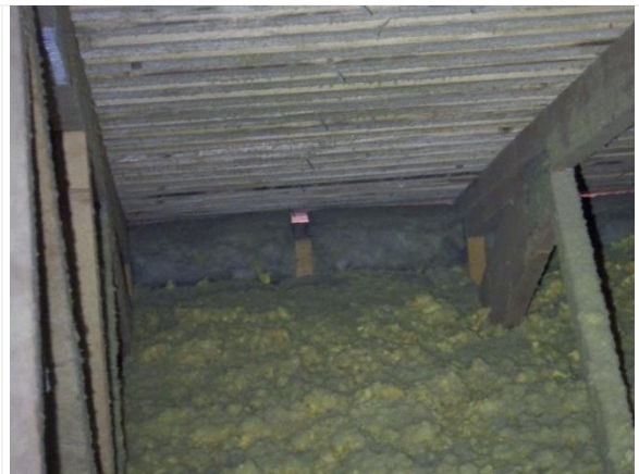
Kuva 29. Osa räystästuuleuksesta on ummistettu mineraalivillalevyillä
