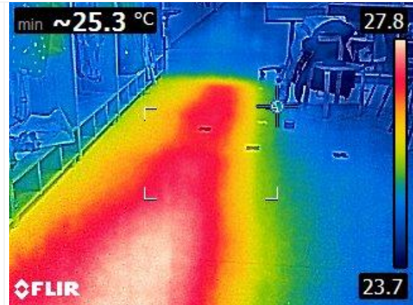
Kuva 25. Käytävän 216 lattiassa (välipohja) havaittiin poikkeava lämmönlähde
