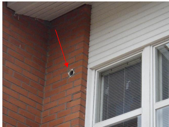
Kuva 9. Vanhaa raitisilma-aukkoa ei ole tukittu ulkopuolelta (tila 201–209)
