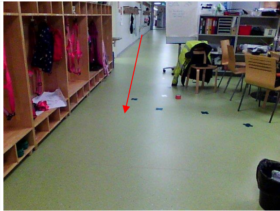
Kuva 24. Käytävän lattiassa havaittiin poikkeavan lämmin kohta (viereinen kuva)
