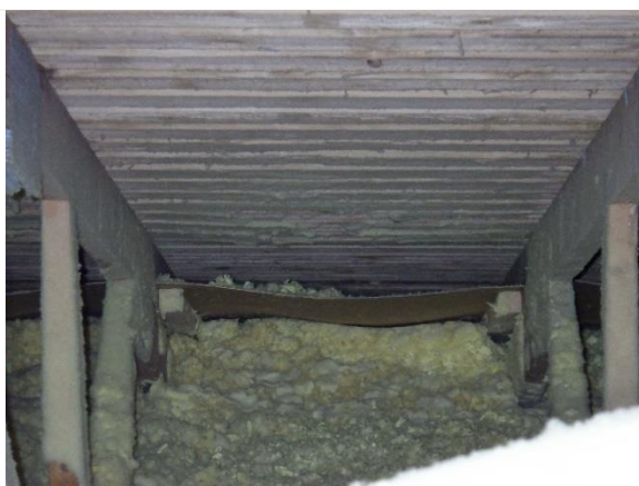
Kuva 30. Puhallusvillan asennuksen yhteydessä on todennäköisesti asennettu räystäälle tuulenhjauslevyt
