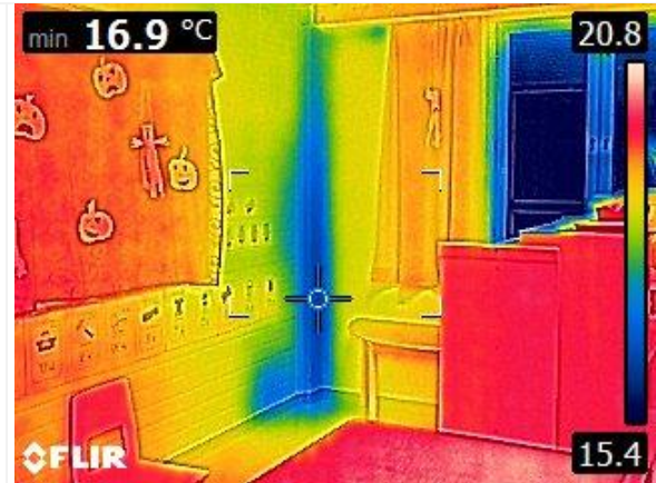
Kuva 18. Tilan 210 ulkonurkassa sijaitseva teräspalkki näkyy sinisenä lämpökamerakuvassa
