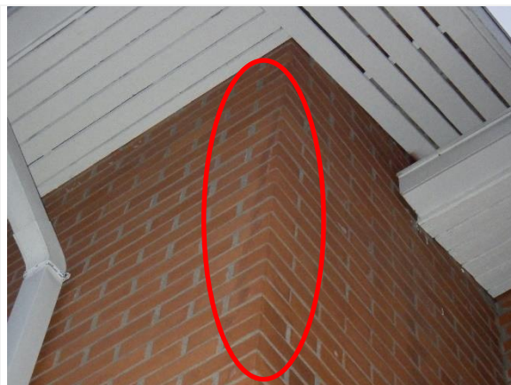
Kuva 15. Tilan 210 ulkonurkkauksessa jälkiä kosteusrasituksesta
