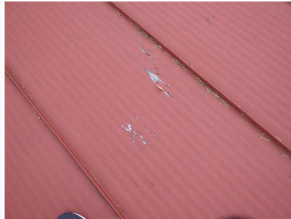
Kuva 32. Vesikatteella havaittiin paikallisia pinnoitteiden vaurioita
