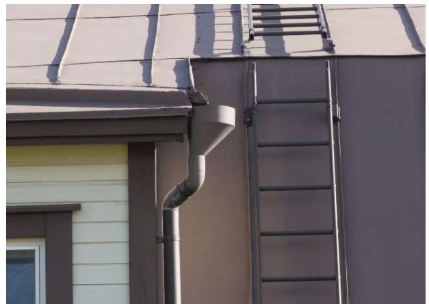
Alkuperäinen vesikate jalkaränneineen ja suppiloineen.
