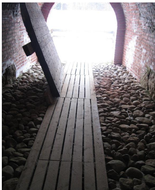
Poterni 1:n hulevesiviemäri
