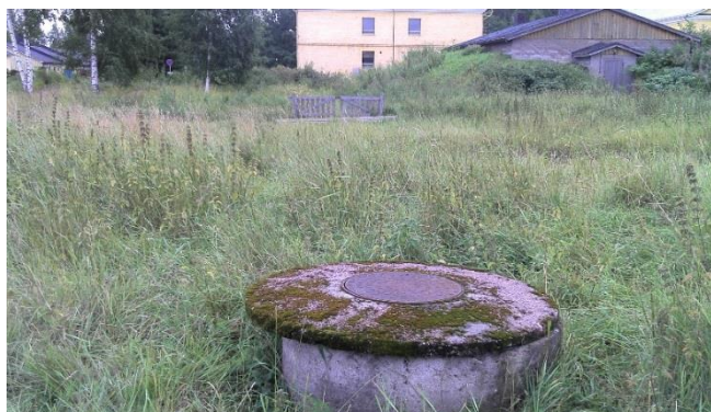
Hulevesiviemärin tarkastuskaivo, alue 15
