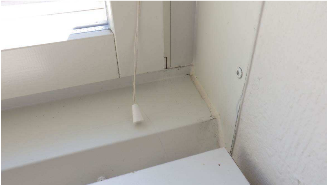
Kuva 3. Ikkunan alapuolen pellitys on tiivistetty vain päädyssä.
