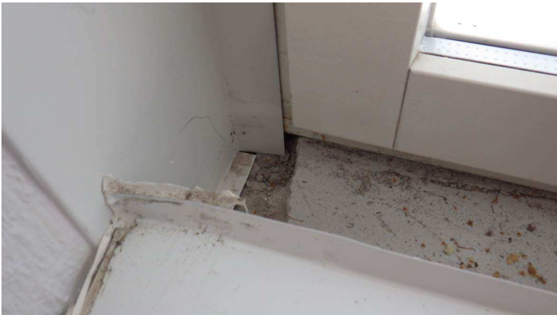
Kuva 4. Ikkunan alapuolelta on selvä vuotoilmareitti.
