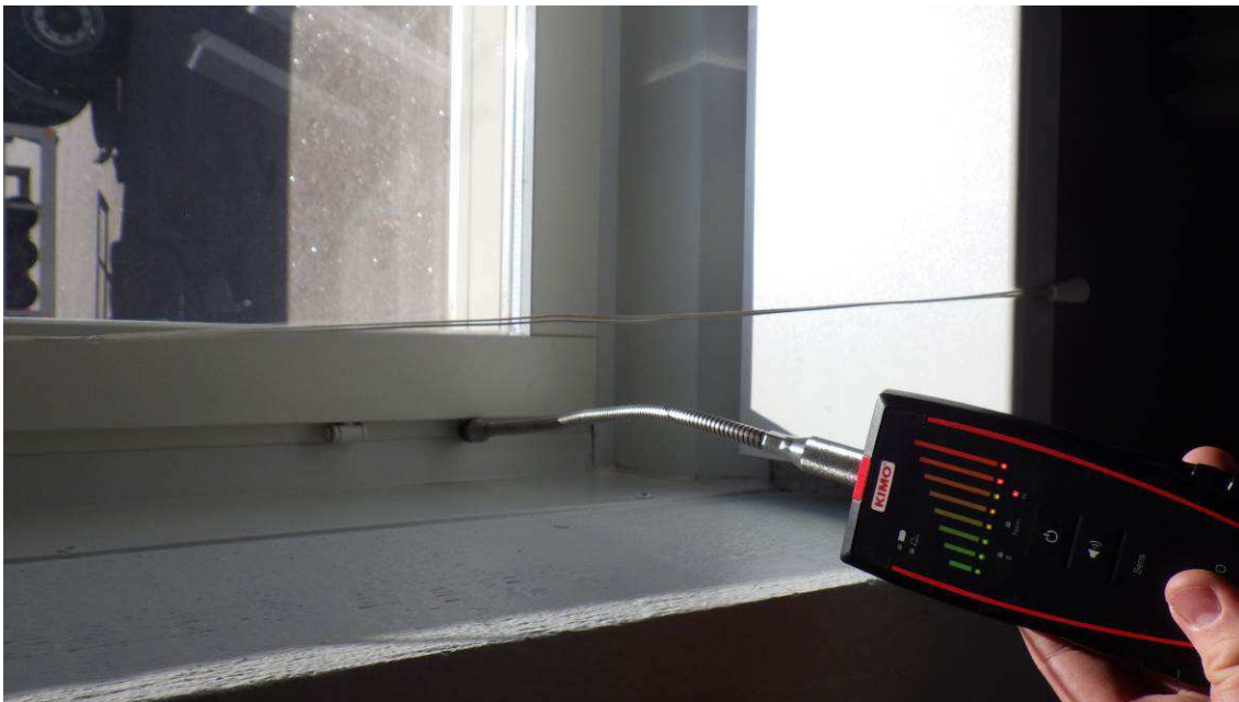
Kuva 6. Ikkunan alapuolen pellityksen päällä havaittiin ilmavuoto.
