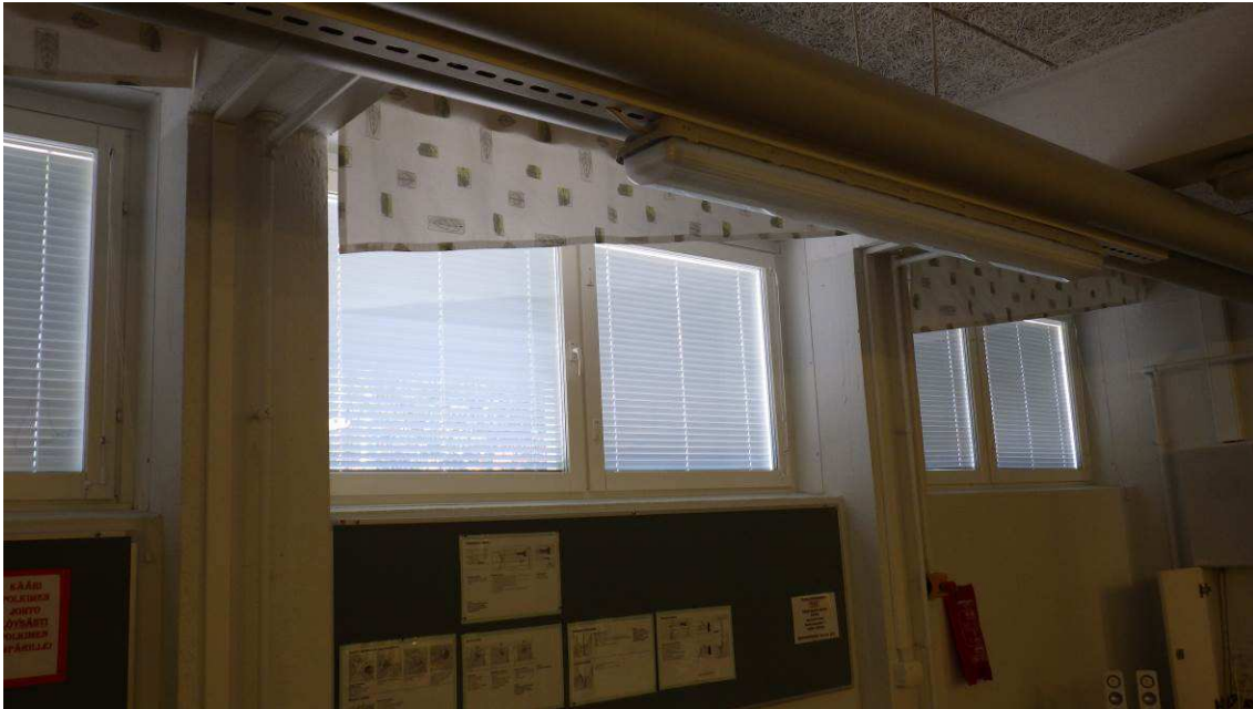
Kuva 7. Luokan 117 ikkunoiden tiivistyksissä havaittiin luokan 128 kanssa yhtenevät puutteet.
