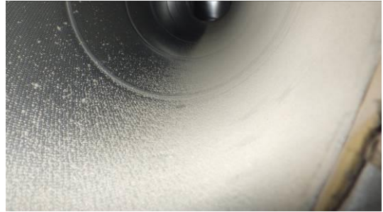
Kanavistoon on kertynyt kohtalaisen runsastakin pölykertymää
