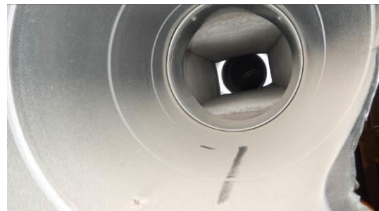
Kanavistoon on kertynyt kohtalaisen runsastakin pölykertymää
