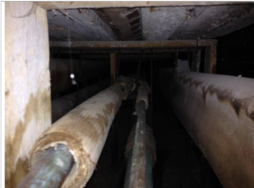
Kuva 7.: kuvaamataidon luokan putkikanaalissa lahonneita muottilautoja ja vaurioituneita putkieristeitä.
