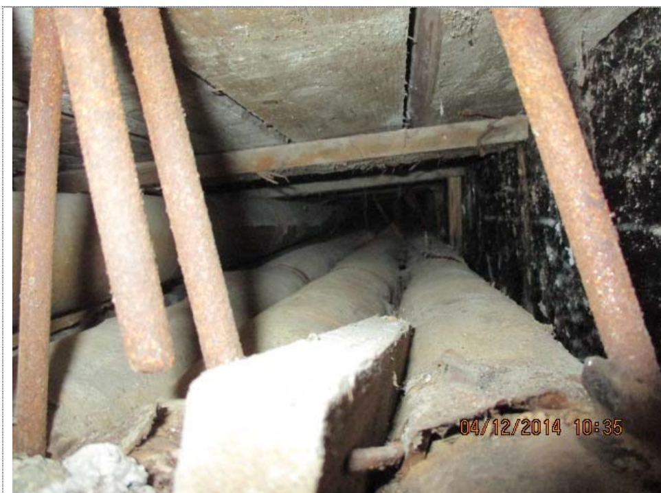
Kuva 2.: Iltapäiväkerhoon johtavan käytävän putkikanaalissa orgaanista materiaalia.
