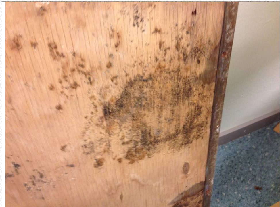
Kuva 3.: Terveystieteiden aulatilassa kanaalin kannessa kosteuden aiheuttamia vaurioita.
