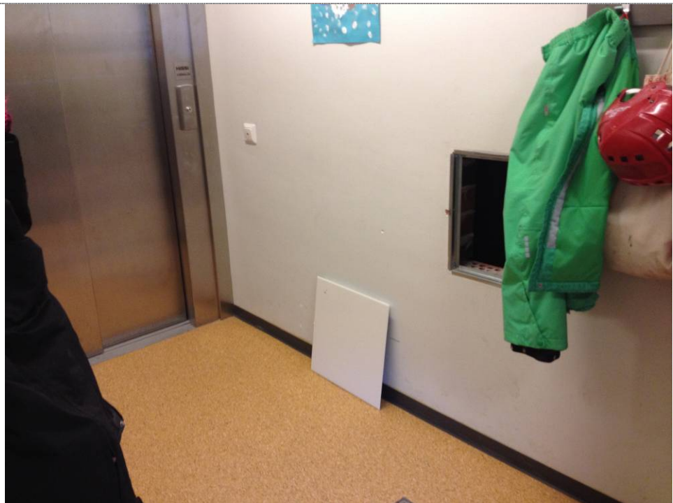
Kuva 17.: Hissin edustalla seinässä luukku välitilaan, josta havaittiin ilmavirta sisätiloihin
