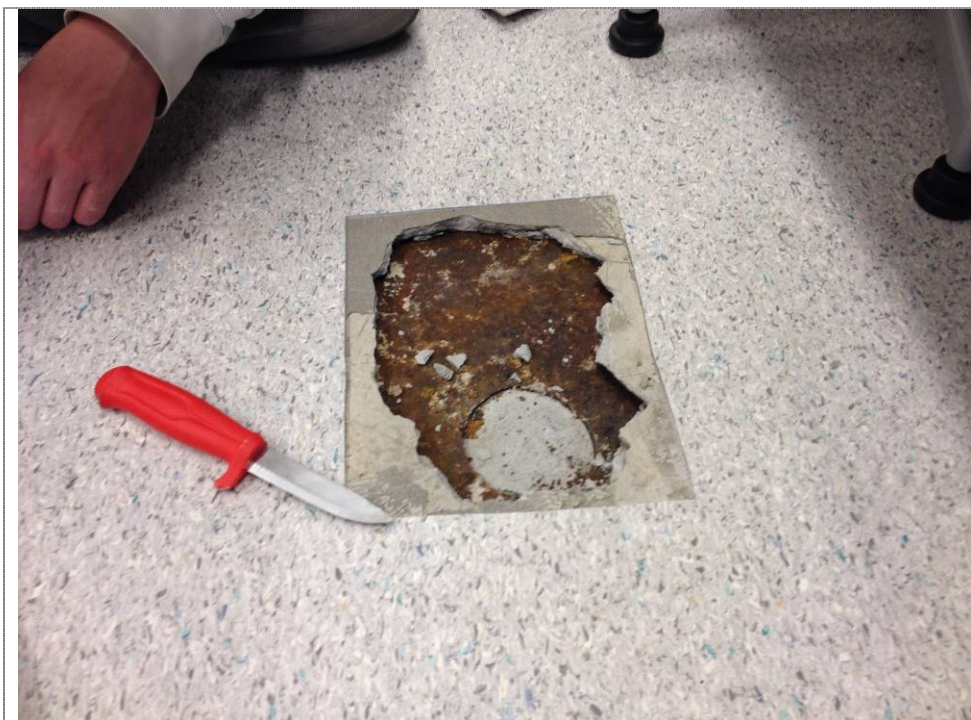
Kuva 8.: Käsityöluokan kosteuspoikkeaman alueella rakenneavaus lattiassa. Lattiapinnoitteen ja tasoitteen alla teräslevy.
