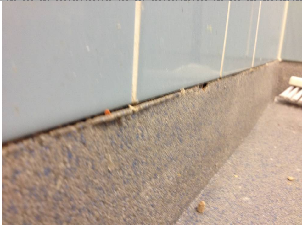
Kuva 15.: Keittiön puolella laatoituksen ja akryylibetonipinnoitteen seinänoston saumassa puutteita
