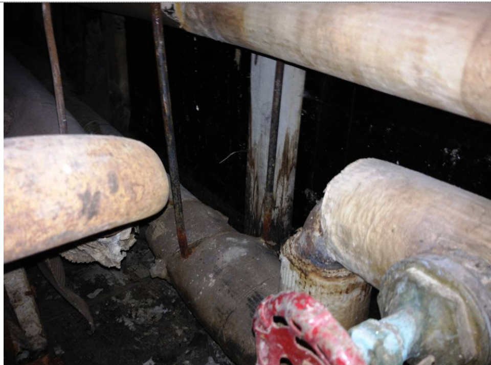
Kuva 6.: Kuvaamataidon luokan putkikanaalissa lahonneita muottilautoja ja vaurioituneita putkieristeitä.
