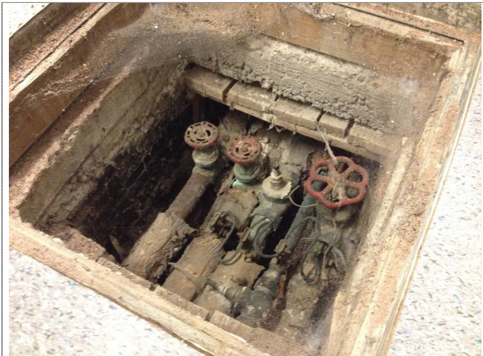
Kuva 1.: Iltapäiväkerhoon johtavan käytävän putkikanaalissa orgaanista materiaalia.
