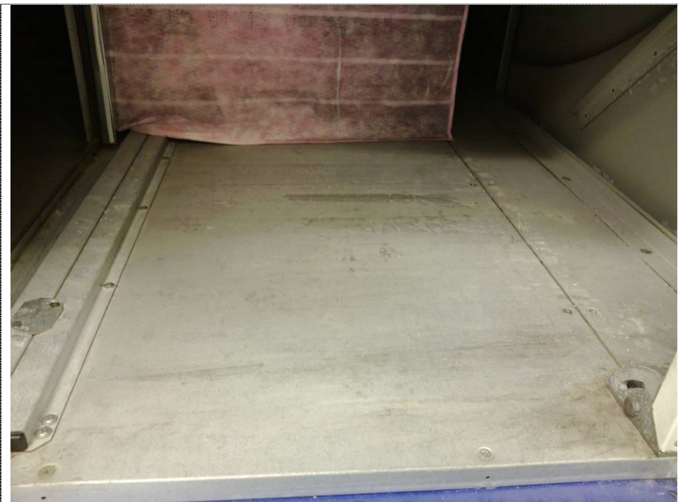
Kuva 24.: Kuivuneita kosteusjälkiä tulosuodatinosassa.
