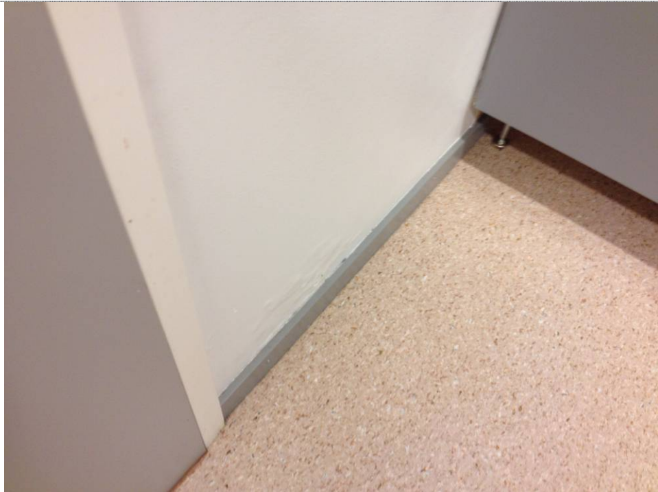
Kuva 11.: Kuvaamataidon luokan ja käytävän väliseinärakenteen alaosassa oli havaittavissa kosteuden aiheuttamia pintavaurioita
