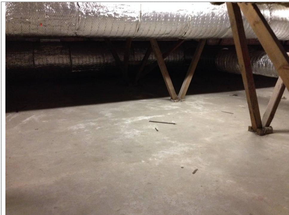
Kuva 22.: Ullakolla vanhoja kuivuneita vesijälkiä palopermannon päällä
