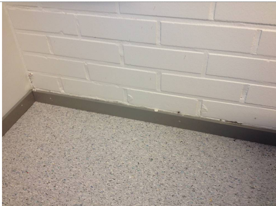
Kuva 14.: Käsityöluokan ja keittiön väliseinärakenteen alaosissa kosteuden aiheuttamia pintavaurioita
