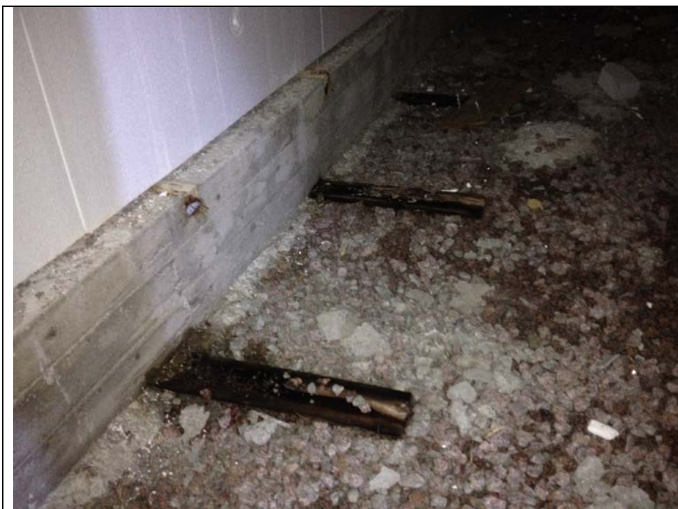
Kuva 3.: Rakenteisiin on jätetty vanhoja muottilautoja.
