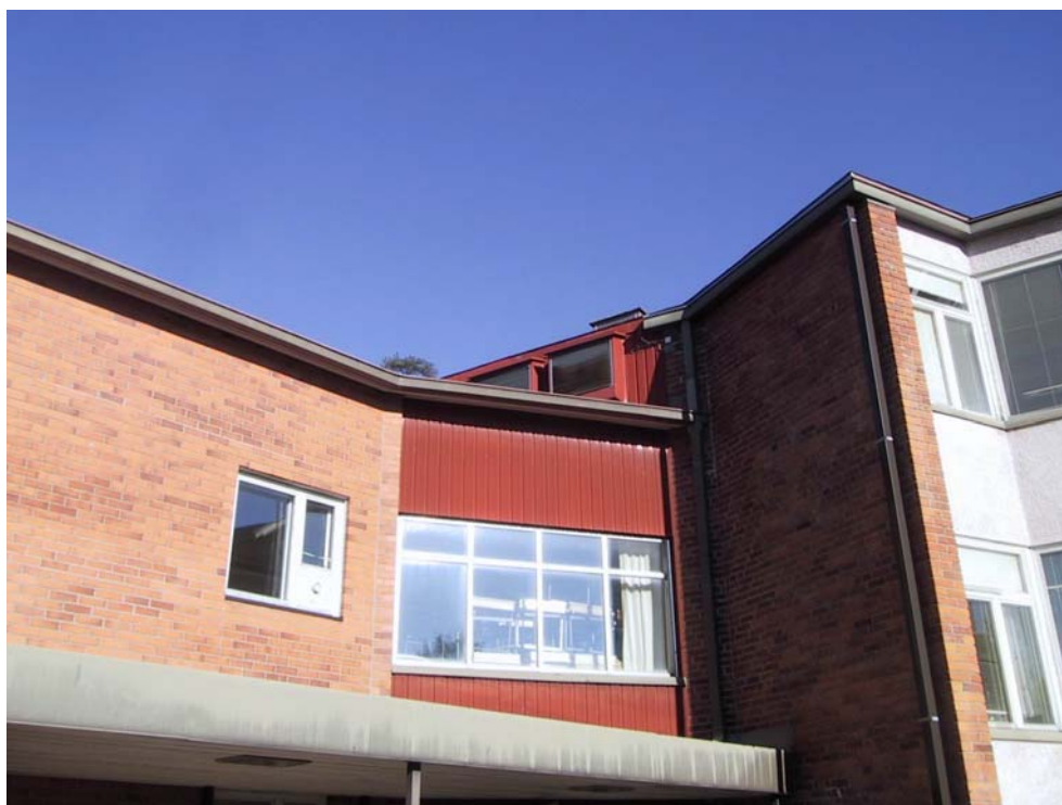
Kuva 14: TK 1 ja -2 säleiköt, luokan 222 ulkoseinää
