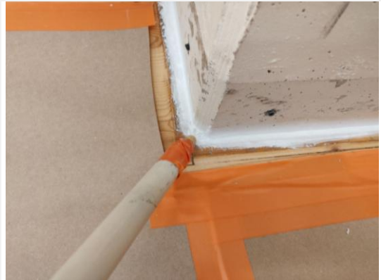
Kuva 3. liikuntahallin lattian ja pilarin rajapinnassa pistemäinen ilmavuoto (tiivistetty heti).
