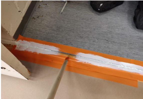
Kuva 2. liikuntahallin ja välinevaraston kynnyksen kohdalla pistemäinen ilmavuoto (tiivistetty heti).
