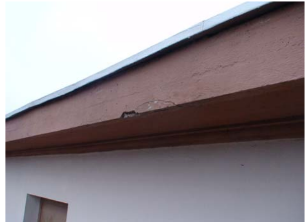
Kuva 11. Betonipalasia irtoamassa räystäästä.
