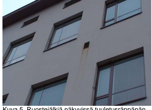
Kuva 5. Ruostejälkiä näkyvissä tuuletusräppään alla.
