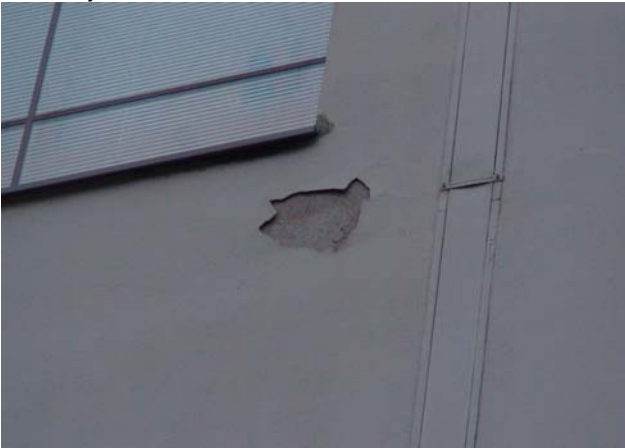
Kuva 2. pintakerros on irronnut rappauksesta.
