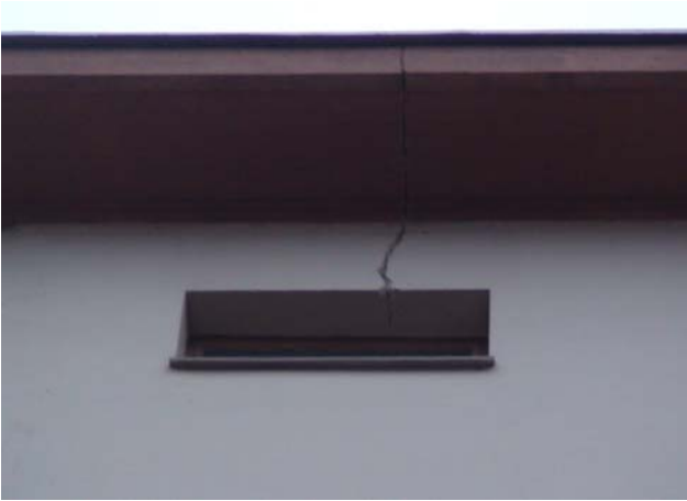
Kuva 1. Räystään liikuntasauaman kohdalla on halkeama julkisivussa.
