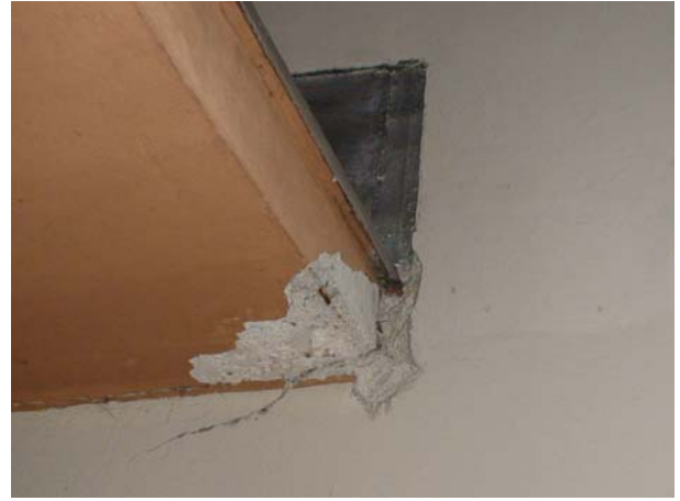
Kuva 4. Puutteellisen liitoksen vuoksi kosteus pääsee rakenteisiin.
