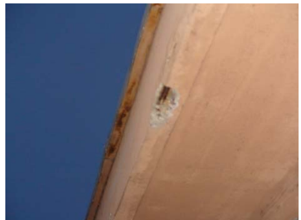
Kuva 12. Teräskorroosion aiheuttama lohkeama.
