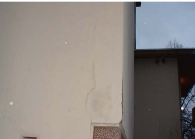
Kuva 3. Halkeamaa sisäpihan nurkalla
