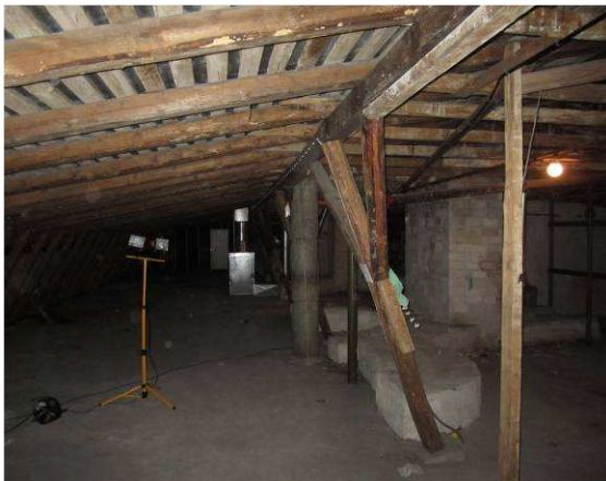
Kanavat ovat galvanoitua peltiä ja muurattuja tiilihormeja.
