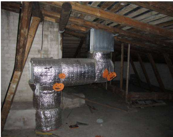
Ullakolla on kaksi poistoilmapuhallinta.
