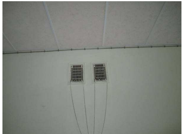
Ritiläventtiilit painovoimaiseen tulo- ja poistoilmastointiin koulun käytävällä.
