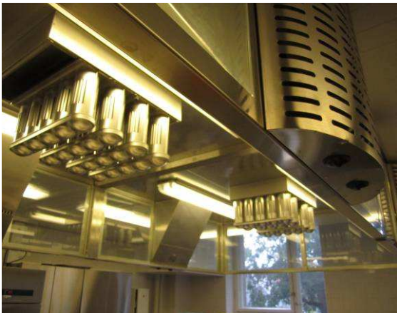
Keittiössä on uusittu kohdepoisto.
